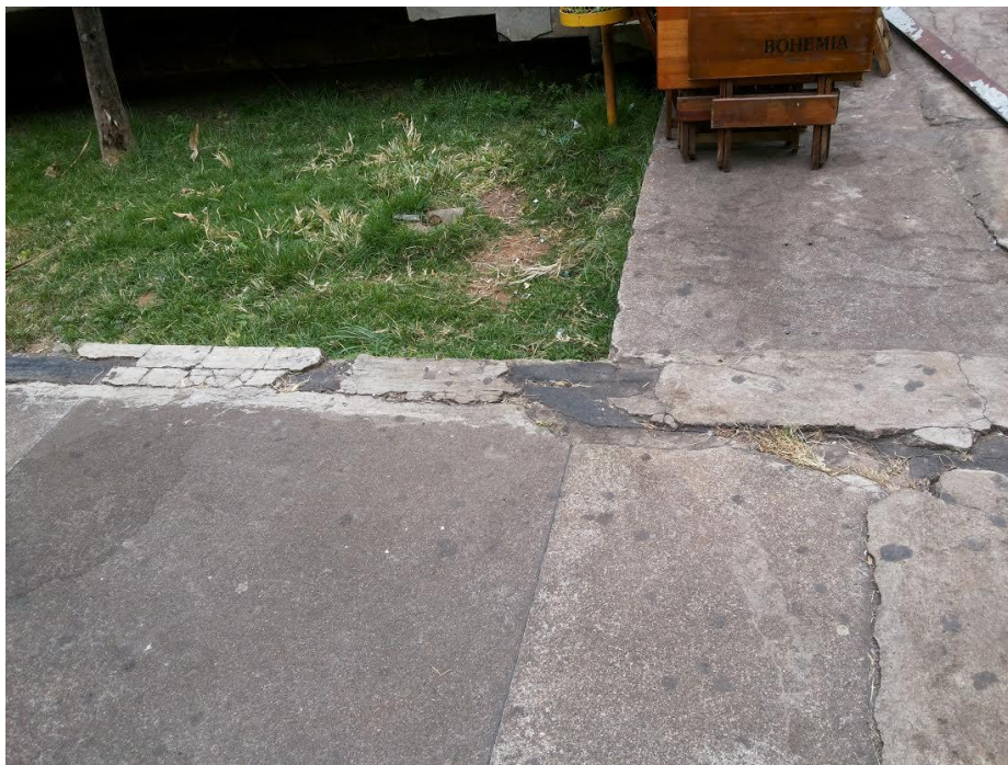
Imagem 09. Piso térreo. Comprometimento da manta de impermeabilização.
