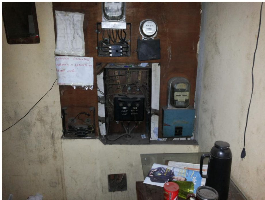
Imagem 26. 1º Subsolo. Quadro elétrico. Fiação velha e aparente.
