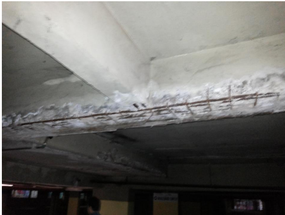
Imagem 17. 1º Subsolo. Viga danificada. Ferragem exposta.
