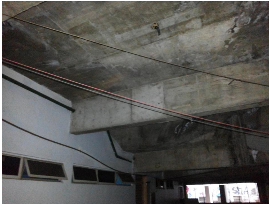
Imagem 27. 1º Subsolo. Laje com umidade. Fiação exposta (‘gato’).
