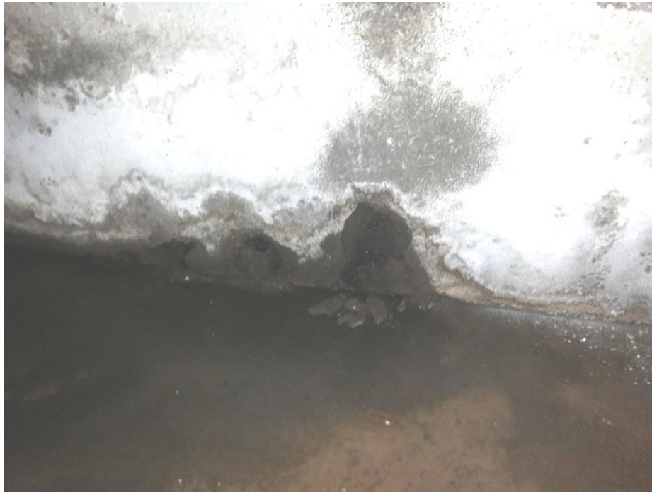
Imagem 31. 2º Subsolo. Infiltração de águas servidas.
