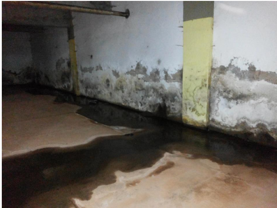
Imagem 29. 2º Subsolo. Infiltração de águas servidas. Mofo nas paredes.
