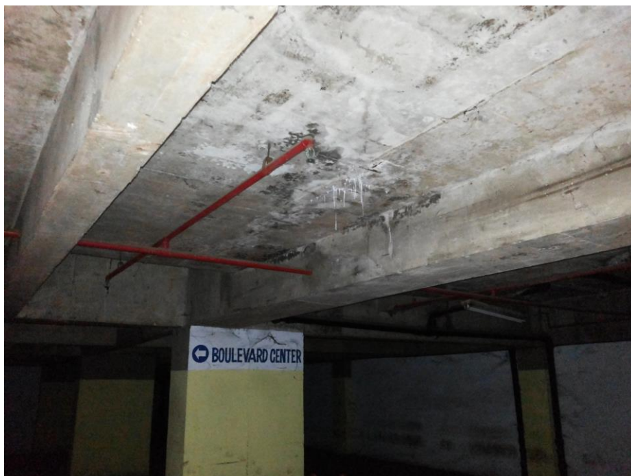
Imagem 19. 1º Subsolo. Infiltração. Estalactites.
