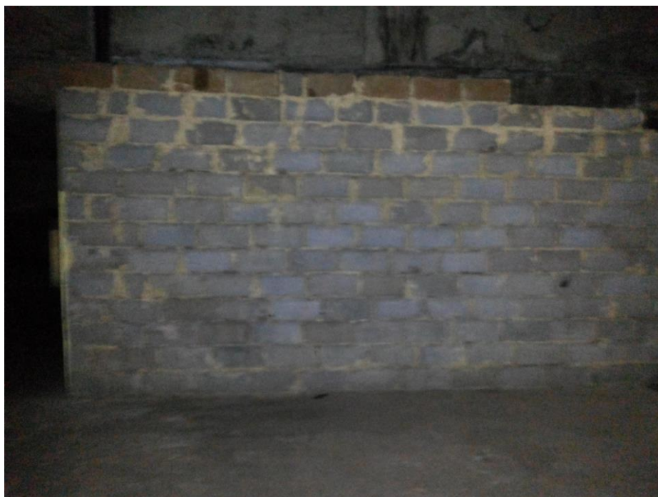
Imagem 12. 1º Subsolo. Parede sem reboco.
