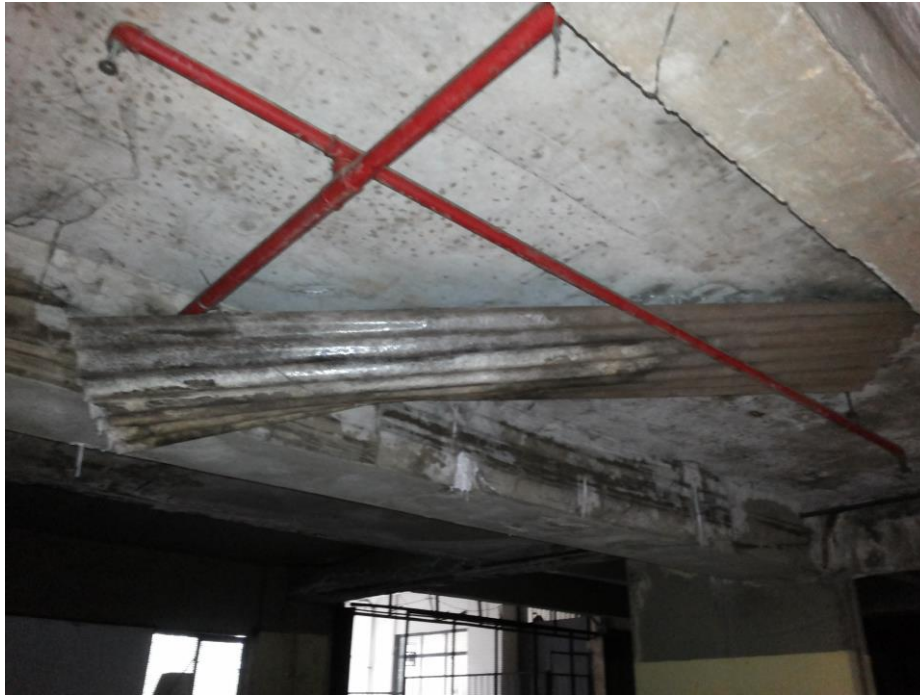
Imagem 13. 1º Subsolo. Infiltração de água. Telha afixada por antigos usuários.
