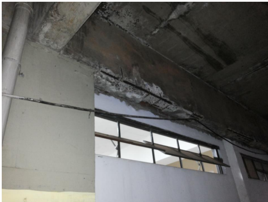
Imagem 18. 1º Subsolo. Viga danificada. Ferragem exposta. Instalações elétricas precárias.
