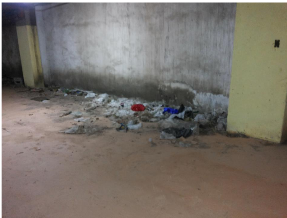
Imagem 34. 2º Subsolo. Deposição de lixo.
