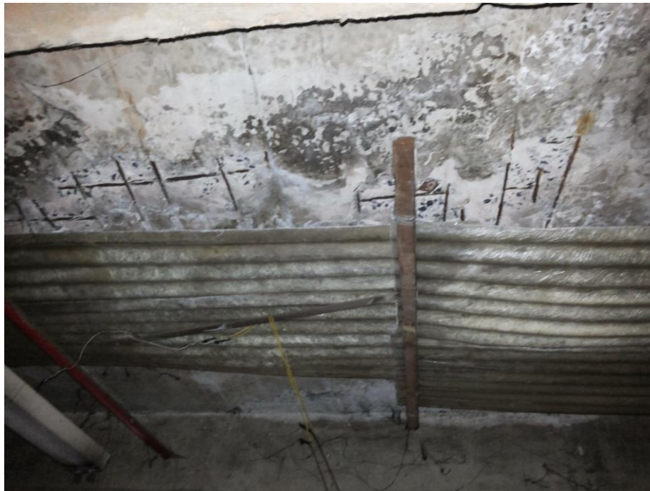
Imagem 21. 1º Subsolo. Laje deteriorada. Corrosão do concreto. Infiltração.
