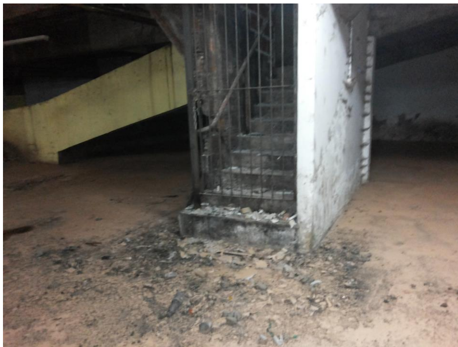
Imagem 28. 2º Subsolo. Escadaria danificada. Parede parcialmente demolida e sem reboco.
