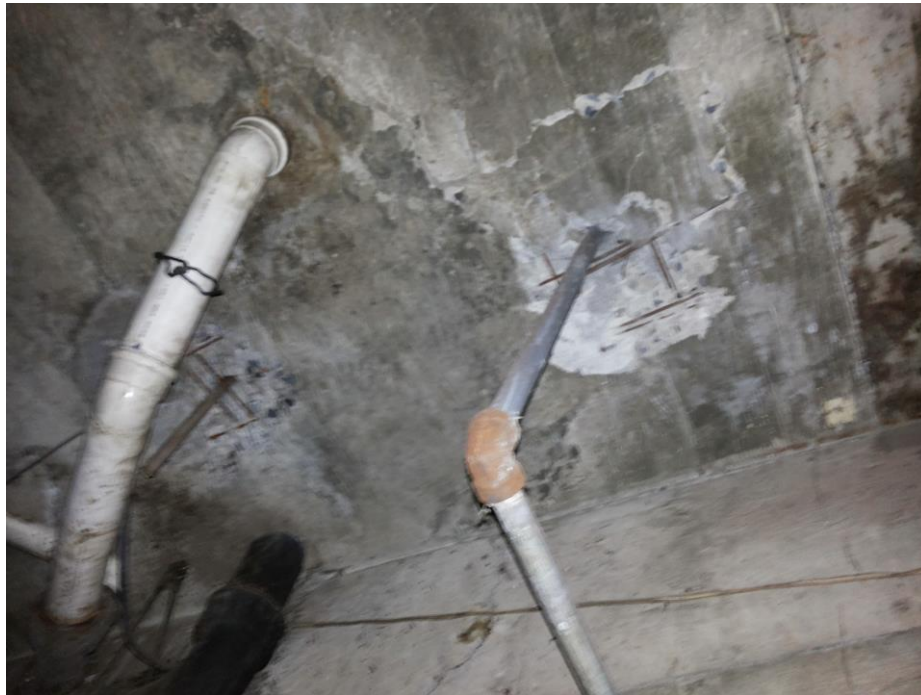
Imagem 23. 1º Subsolo. Laje deteriorada. Corrosão do concreto. Infiltração.
