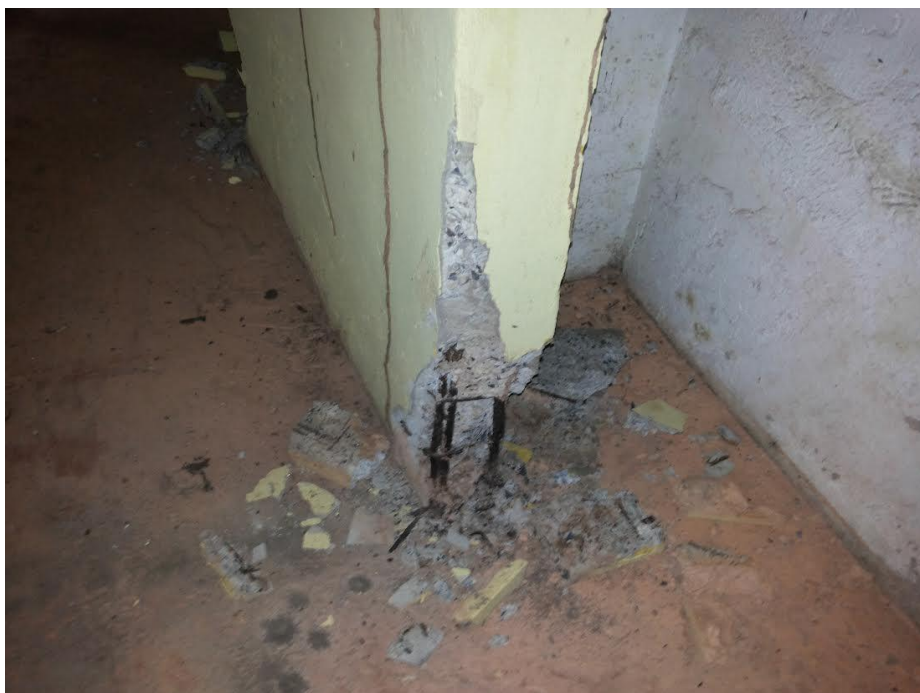
Imagem 15. 1º Subsolo. Coluna danificada. Ferragem exposta.
