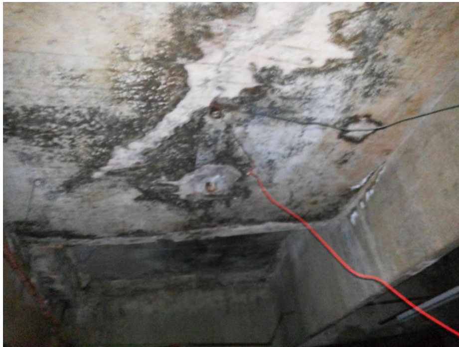
Imagem 25. 1º Subsolo. Laje com umidade. Fiação exposta (“gato”).
