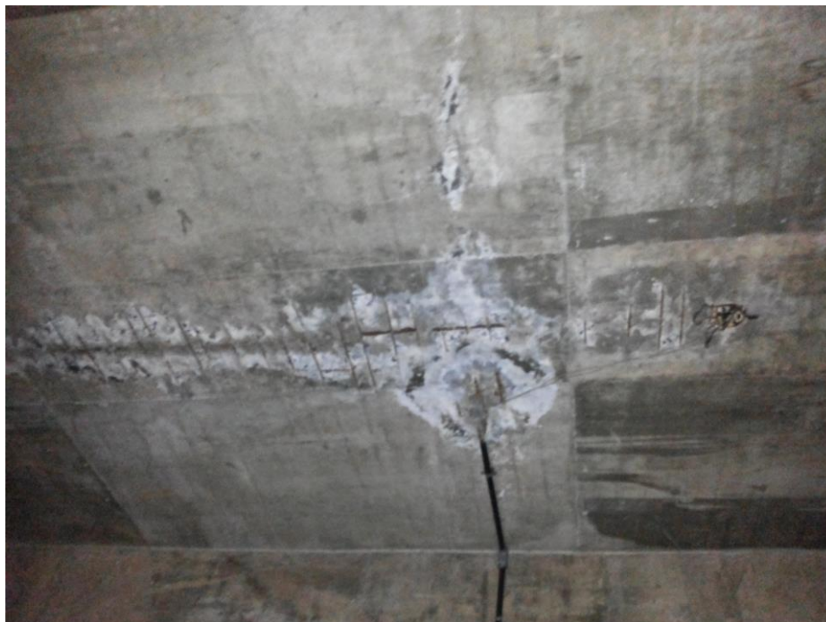
Imagem 22. 1º Subsolo. Laje deteriorada. Corrosão do concreto. Infiltração.
