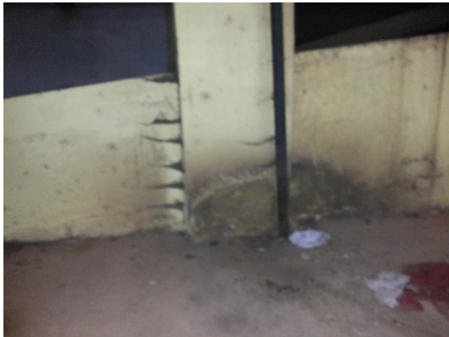
Imagem 33. 2º Subsolo. Testemunho de vazamento aparentemente sanado.
