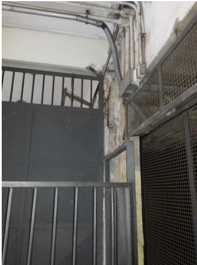
Imagem 11. Acesso ao 1º Subsolo. Detalhe da coluna danificada.
