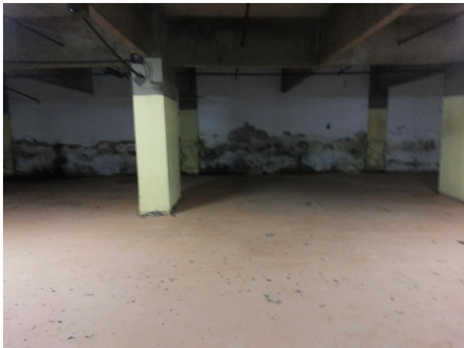
Imagem 30. 2º Subsolo. Mofo nas paredes.
