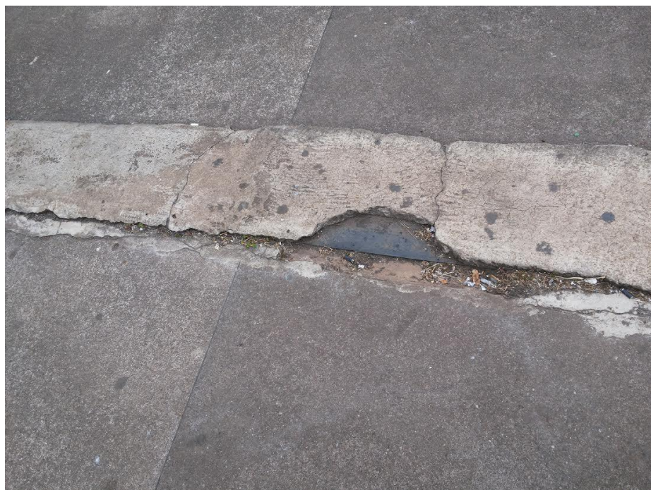
Imagem 08. Piso térreo. Comprometimento da manta de impermeabilização.
