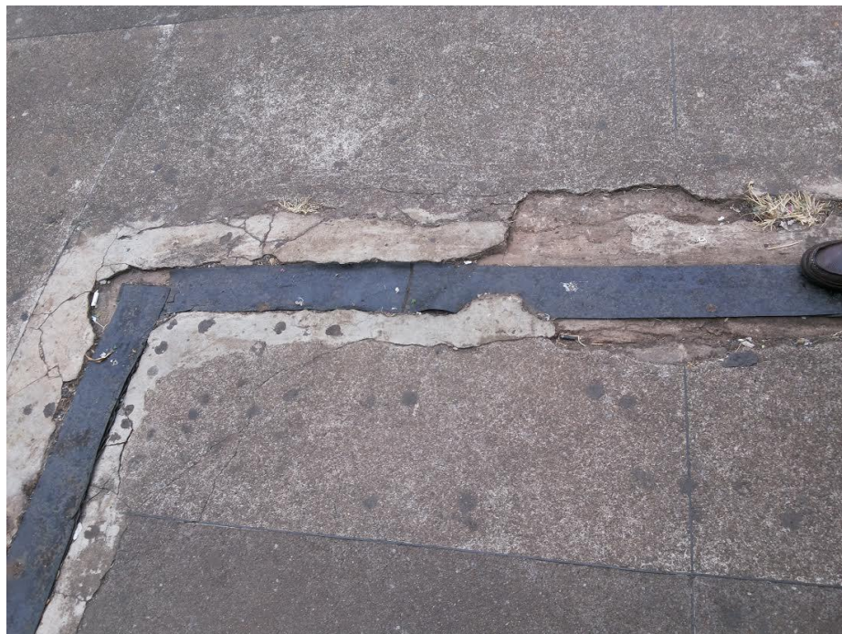
Imagem 07. Piso térreo. Comprometimento da manta de impermeabilização.
