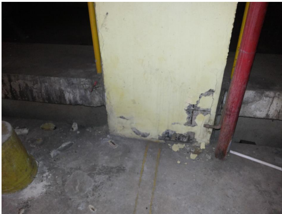
Imagem 14. 1º Subsolo. Coluna danificada.
