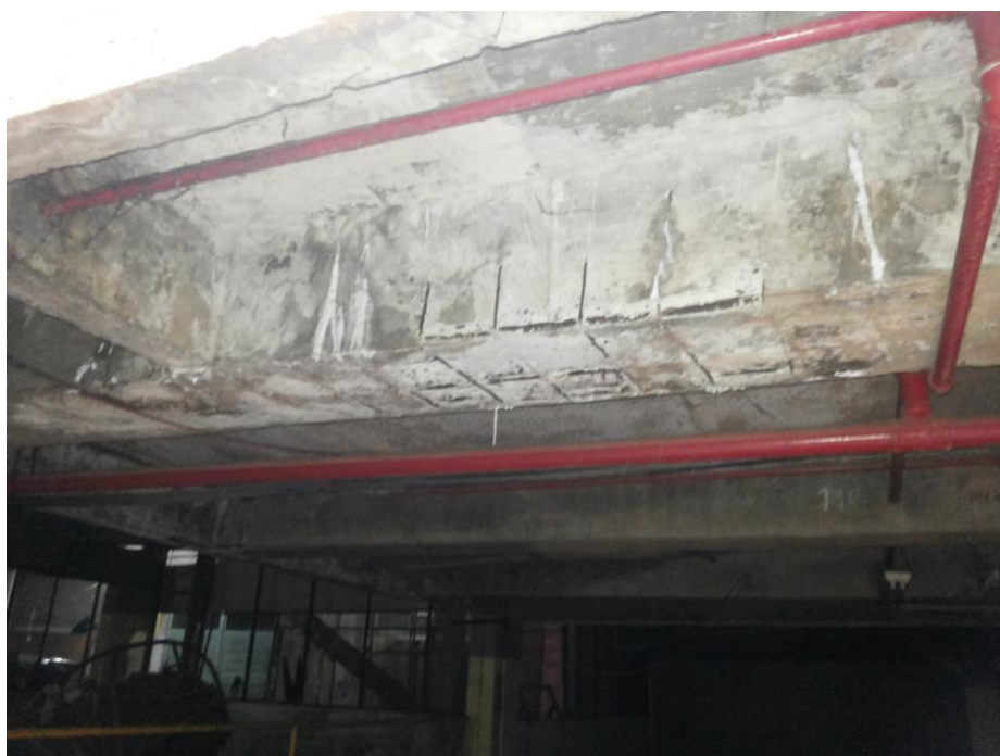
Imagem 16. 1º Subsolo. Viga danificada. Ferragem exposta. Infiltração.
