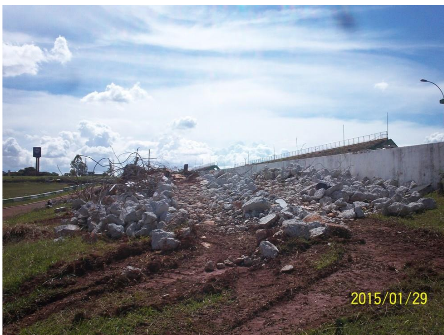
Figura 11. Escombros dos antigos boxes
