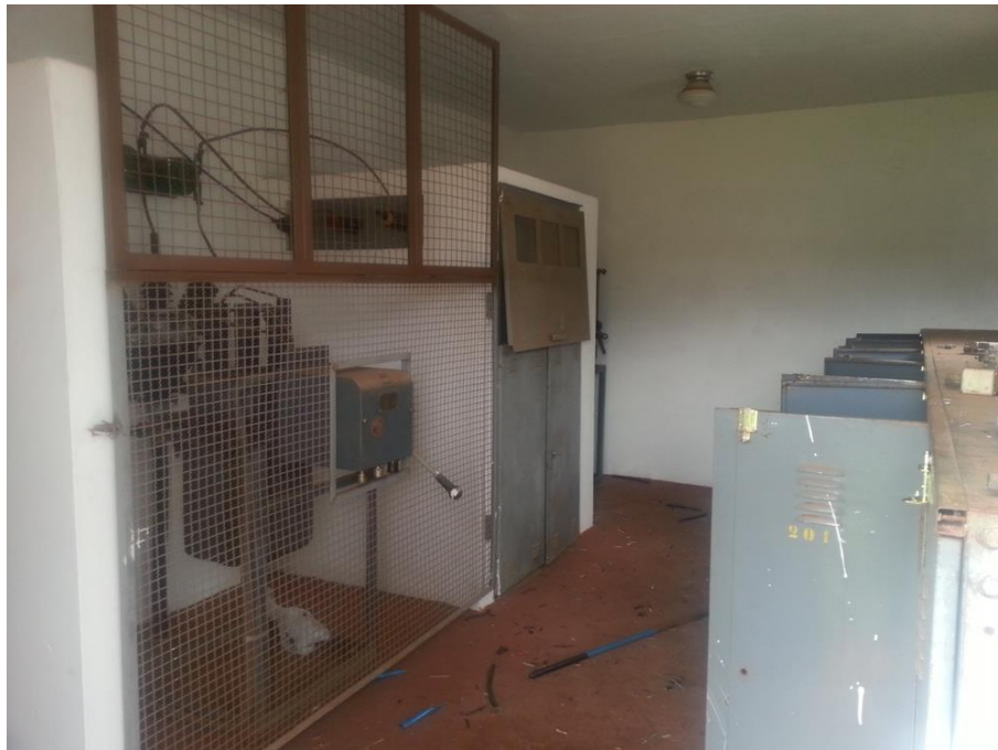
Figura 13. Visão interna da subestação de energia elétrica
