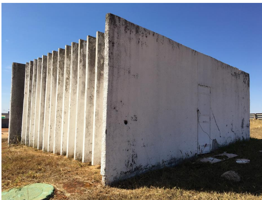
Figura 12. Visão externa da subestação de energia elétrica
