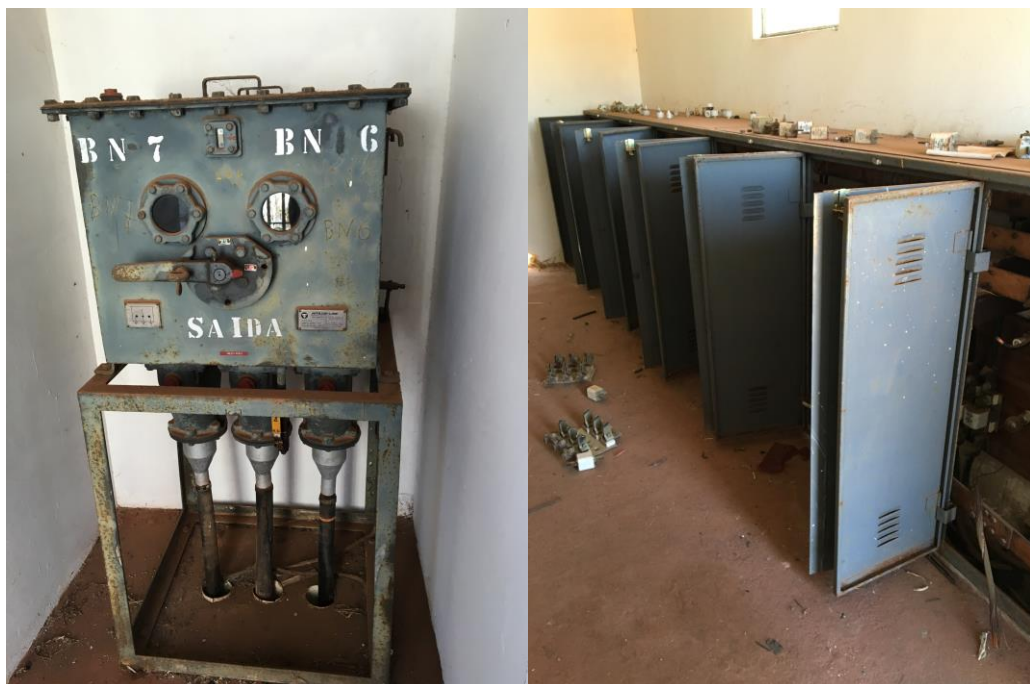
Figura 14. Detalhes da subestação de energia elétrica
