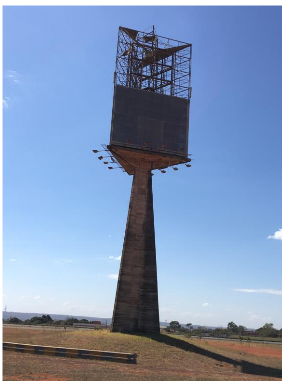
Figura 18. Painel Eletrônico danificado
