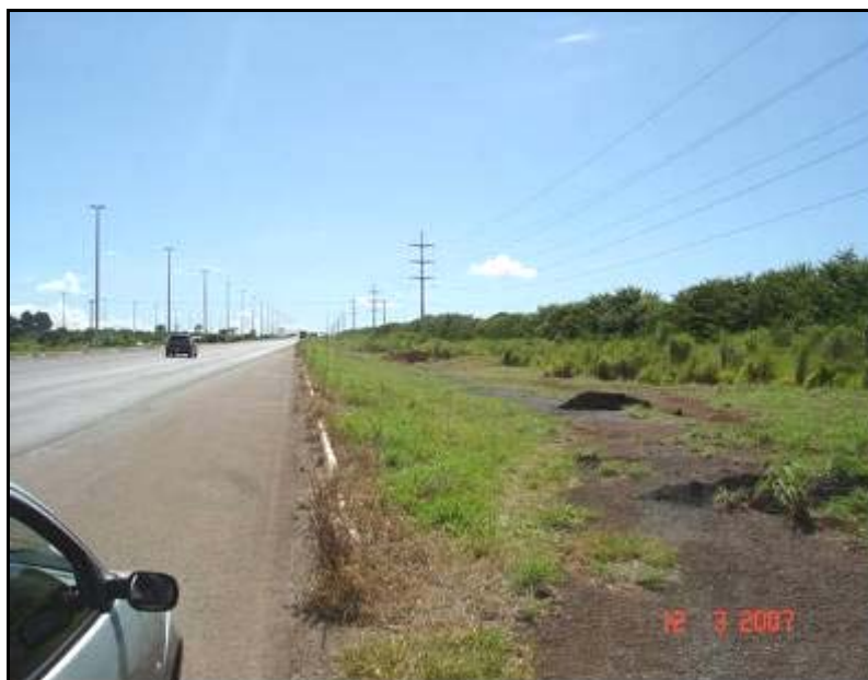
Ilustração 39: Linha de transmissão de energia elétrica, em alta tensão.
