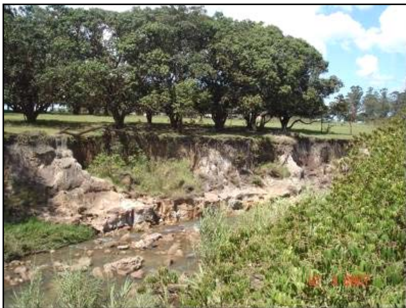
Ilustração 37: Erosão nas margens do córrego Estiva.
