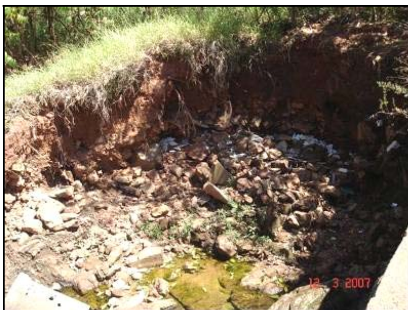
Ilustração 38: Processo erosivo na saída do Lançamento nº.04.
