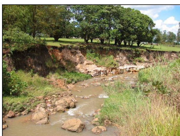
Figura 7.2.1 - Ponto localizado próximo à drenagem pluvial - Córrego Estiva.
