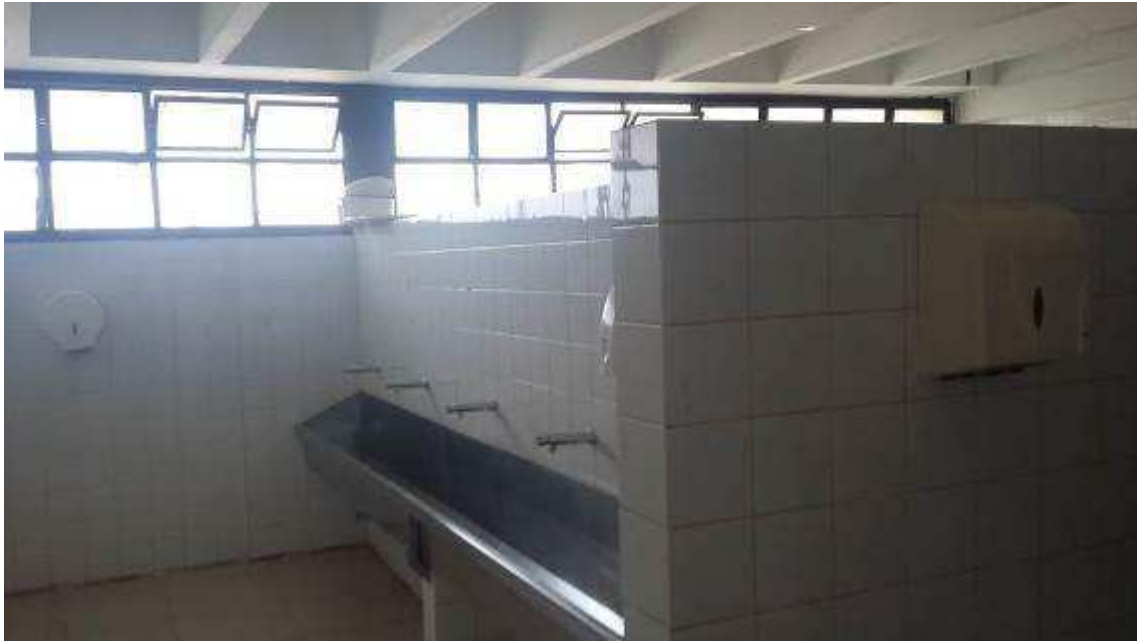
Mau cheiro no banheiro masculino devido ao sistema utilizado de descarga do mictório.
