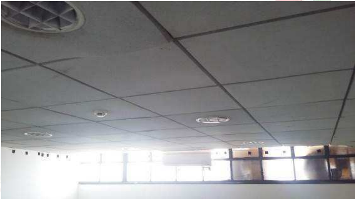
Placas de proteção acústica no forro em desacordo com as normas de segurança, produto toxico devendo ser substituído.
