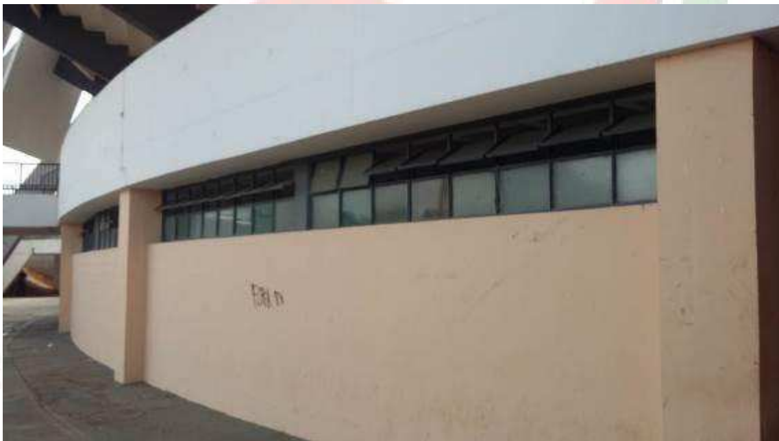
Todo o perímetro da edificação apresenta falha ou ausência de manutenção.
