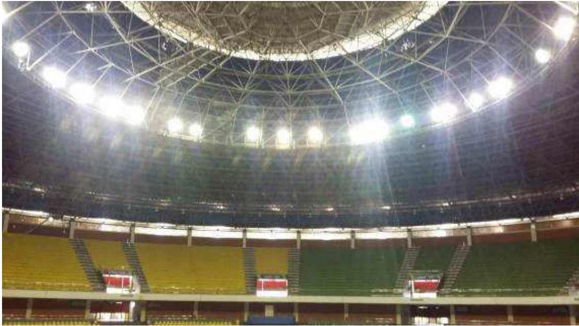
Vista parcial do sistema de cobertura espacial do estádio, apresentando varias anomalias com vazamento, durante as chuvas podendo evoluir para perda de eficiência de suporte da estrutura, já que a mesma e toda em peça metálica tubular executada em fixação mecânica.
