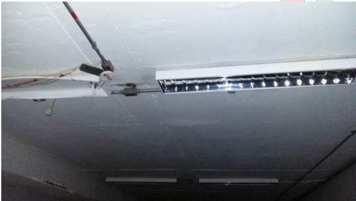
Necessidade de substituição do sistema de iluminação
