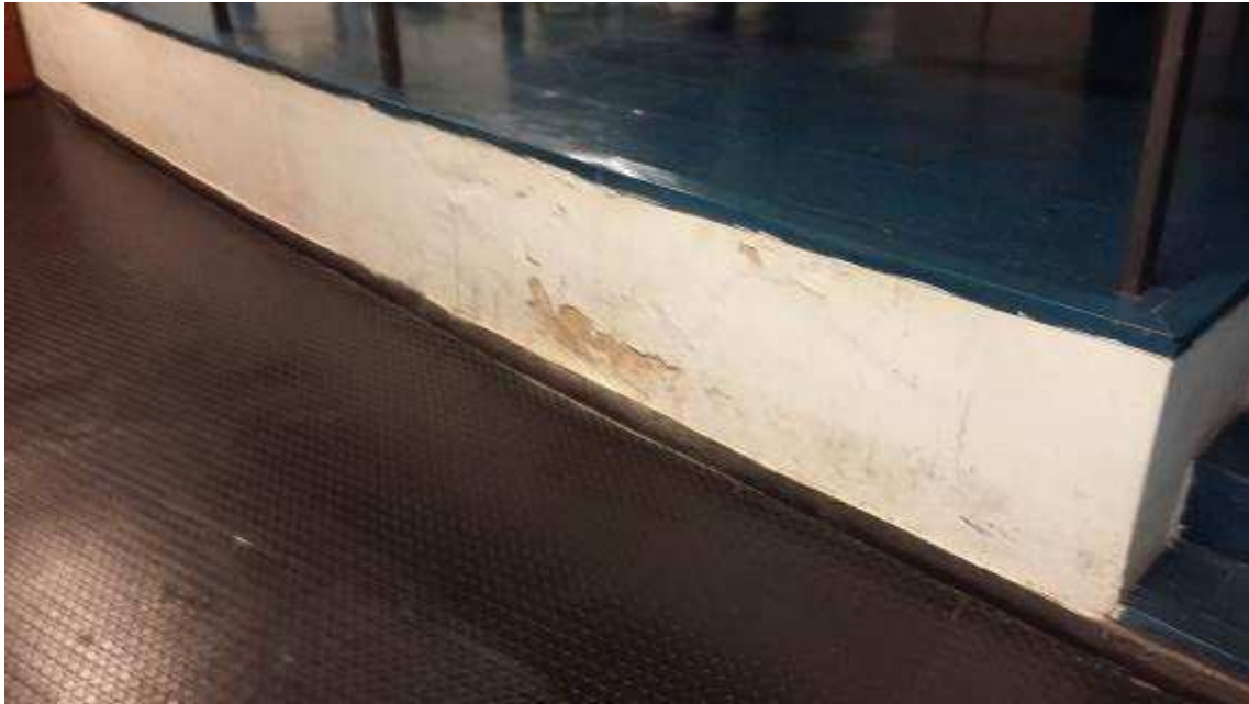
Instalação de anomalias em toda área interna do estádio em paredes, pisos com infiltrações no teto na sala utilizada pela administração do estádio.
