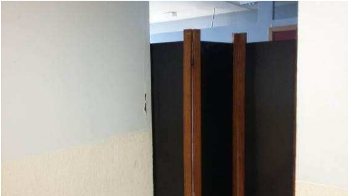
Falta de correção preventiva
