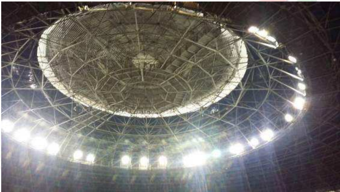
Vista parcial do sistema de cobertura do estádio, com falha no sistema de iluminação, devendo o mesmo ser substituído e modernizado para que sua eficiência atenda a necessidade dos eventos realizados principalmente no quesito segura aos usuários.
