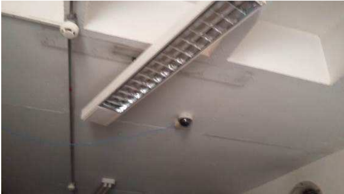
Readequação do sistema de combate a Incêndio, detectores de fumaça, sprink, extintores, hidrante, SPDA, saídas de emergência, entre outros itens de segurança em área de evento com grande público. Readequação do sistema elétrico (quadros de distribuição, disjuntores, cabeamento, iluminação etc.).
