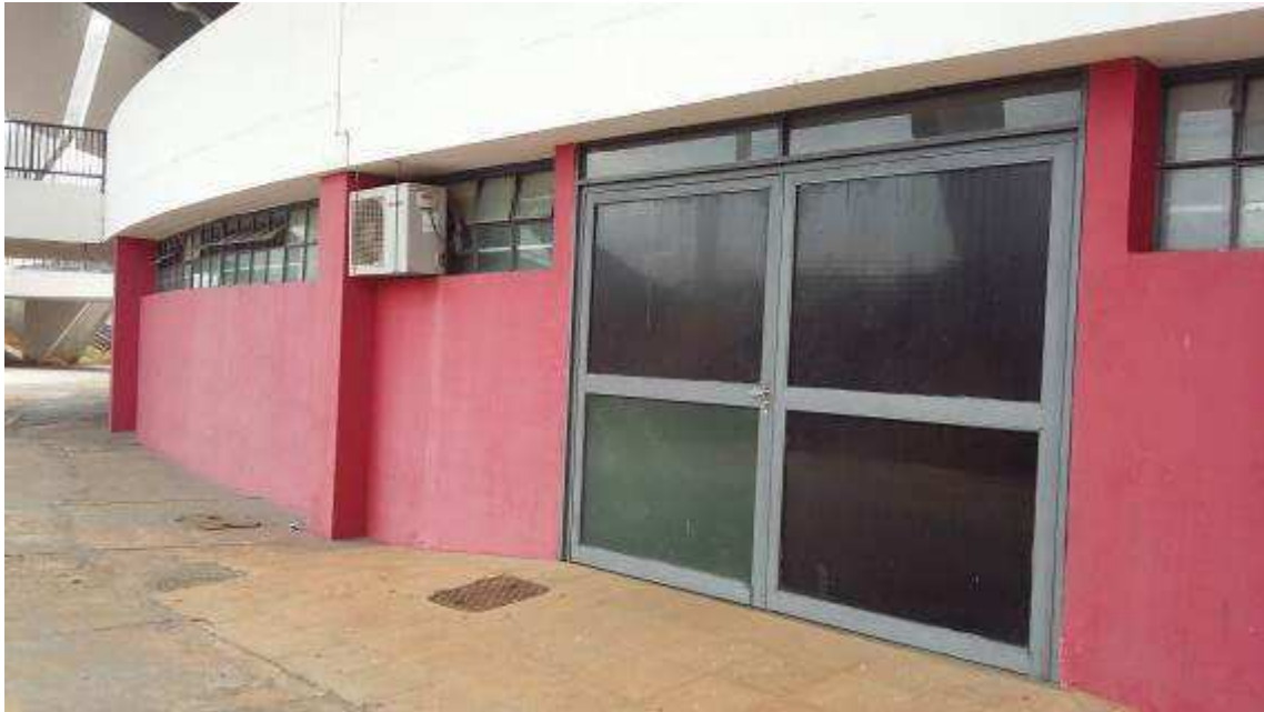
Necessidade de pintura geral externa na fachada
