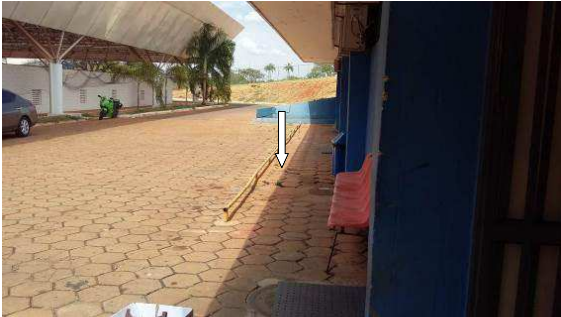
Area externa com vários pontos de anomalias e irregularidades
