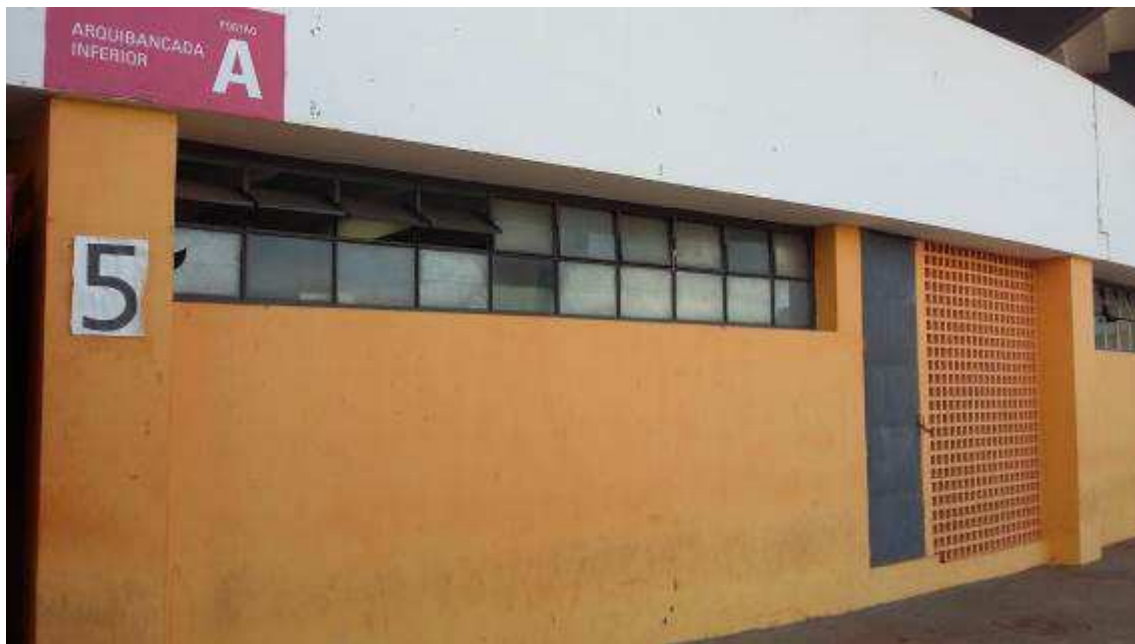
Fachada já apresenta anomalias devido falta de manutenção corretiva
