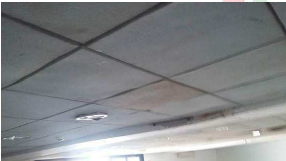
Sistema de proteção acústica dos camarins fora de norma e com péssima conservação, infiltração pelo teto devido à ausência de manutenção nos sistemas de hidro sanitária do estádio.
