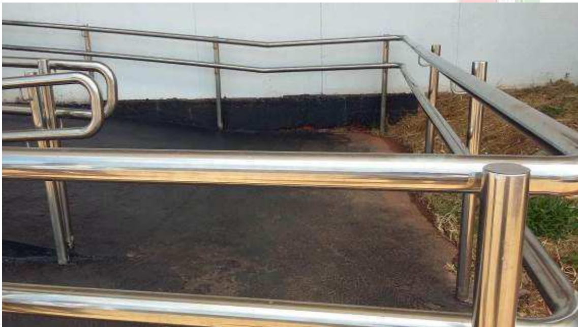
Acesso ao ginásio pela rampa de deficiente físico, falta de identificação e piso inadequado.
