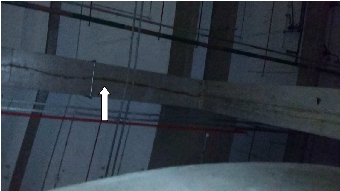
Figura 02 – Descontinuidade na junta de dilatação.
