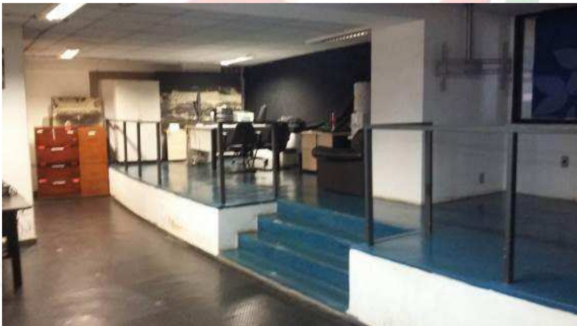
Sala da administração com varias patologias instalada no piso, parede e teto.
