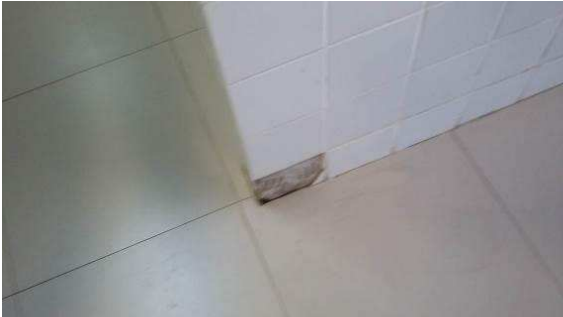
Necessidade de reforma conforme mostra figuras
