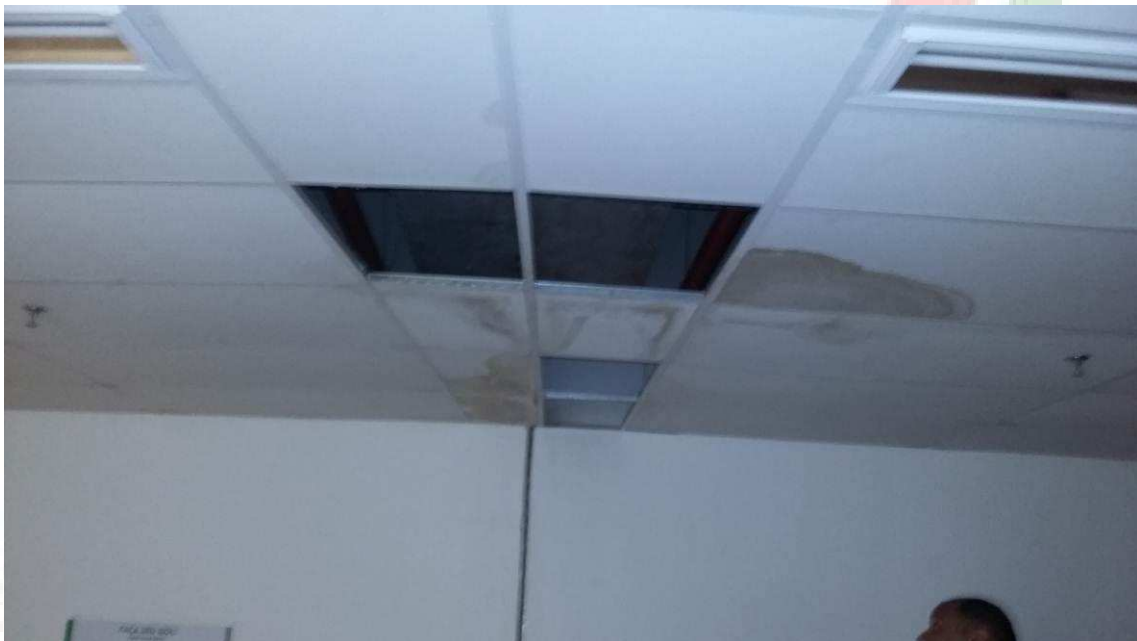
Figura 07 – Forro danificado devido à passagem de água pelas juntas de dilatação isto acontece em todos os raios, danificando os revestimentos inferiores.
