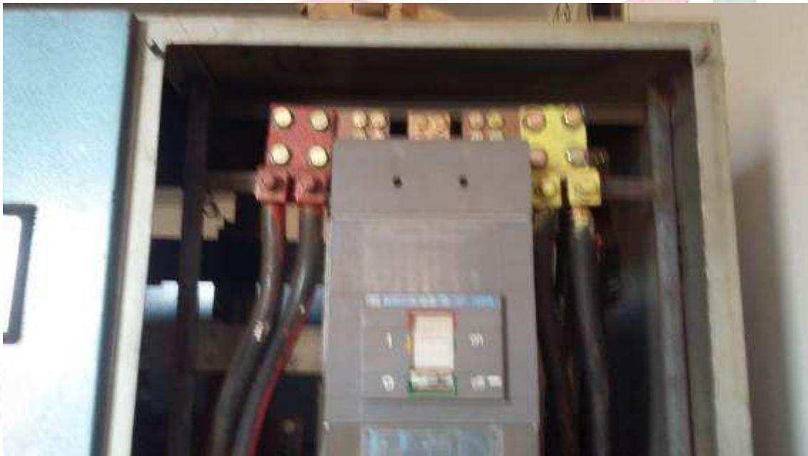
Possibilidade de acidente falta de proteção
