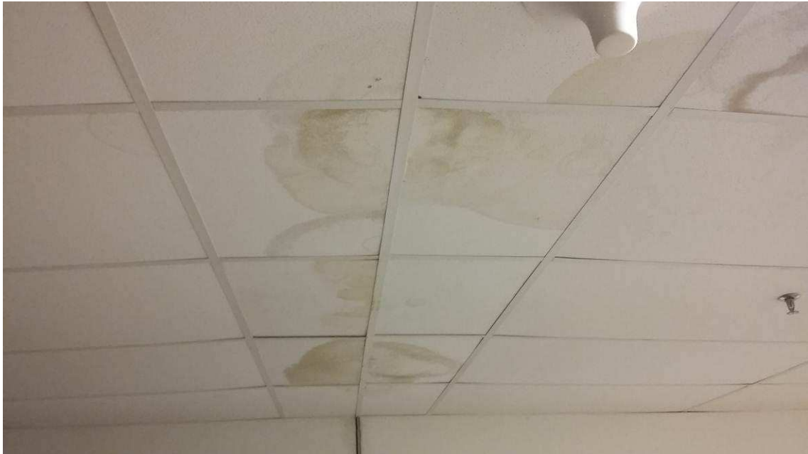
Figura 08 – Forro danificado devido à passagem de água pelas juntas de dilatação isto acontece em todos os raios, danificando os revestimentos inferiores.
