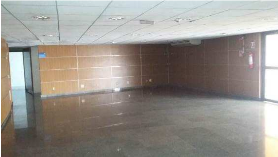
Tribuna de Honra, precisando de intervenções de correções no sistema de iluminação e forro.
