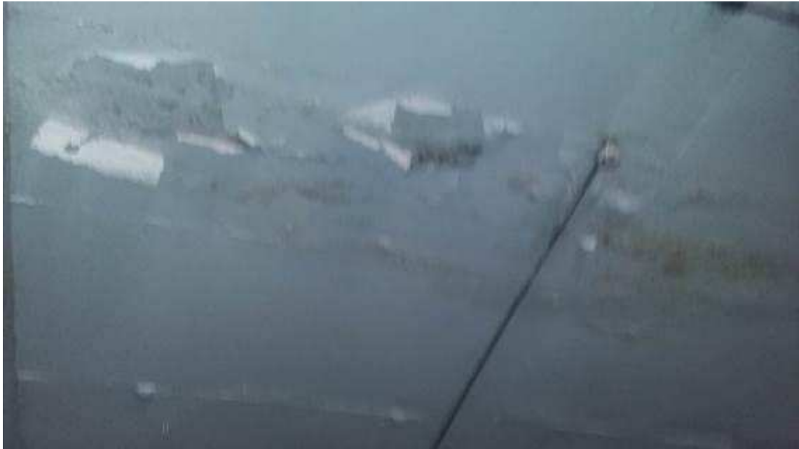
Patologia em laje devido a infiltrações
