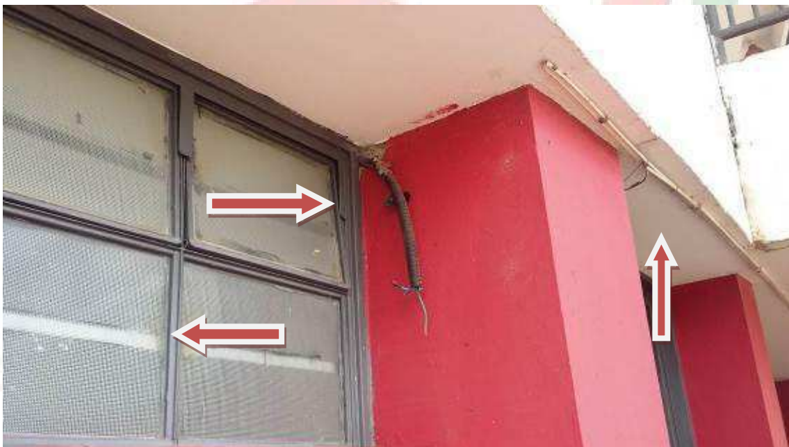
Vidraças mal conservadas, fiação expostas e improvisadas e pintura desgastada (setas vermelhas).
