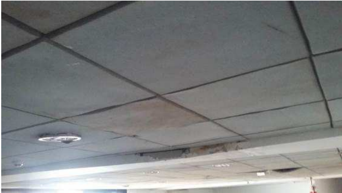
Sistema de proteção acústica dos camarins fora de norma e com péssima conservação
