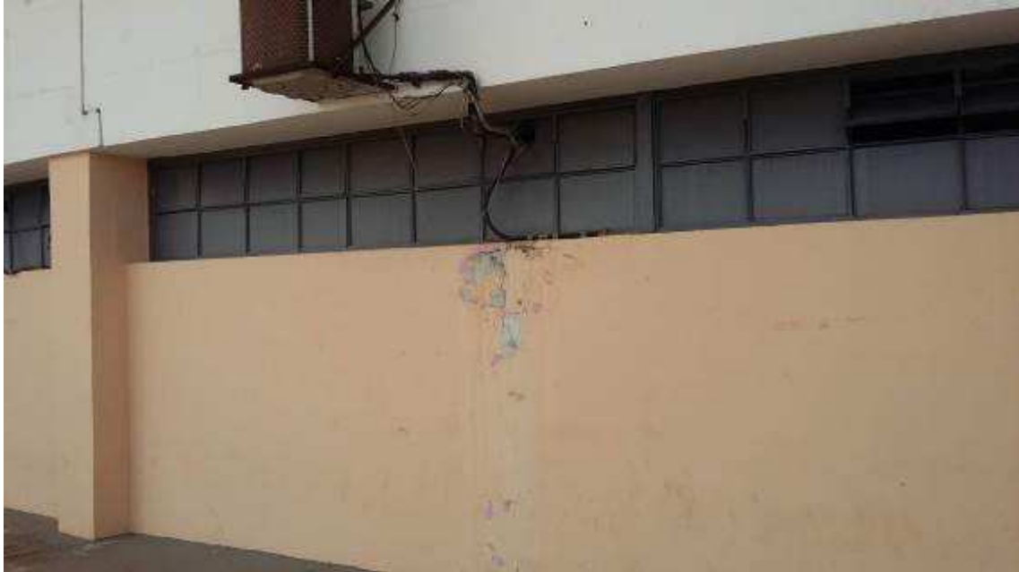
Aparelho de ar condicionado com instalação má executada, danificando a fachada, indicação aparecimento de patologia na edificação.
