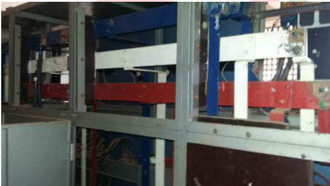
CASA DE FORÇA - Barramento sem nenhuma proteção
