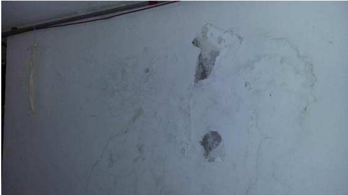
Instalação de anomalias em toda área interna do estádio em paredes, pisos com infiltrações no teto.
