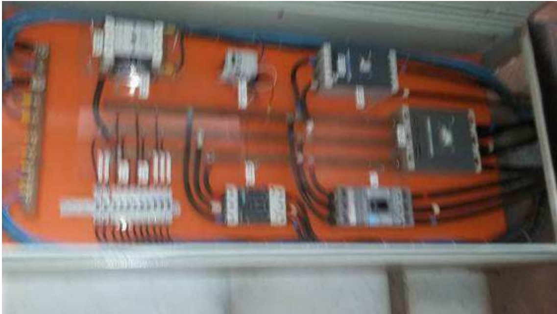
Quadro com modificações recente, sem proteção.
