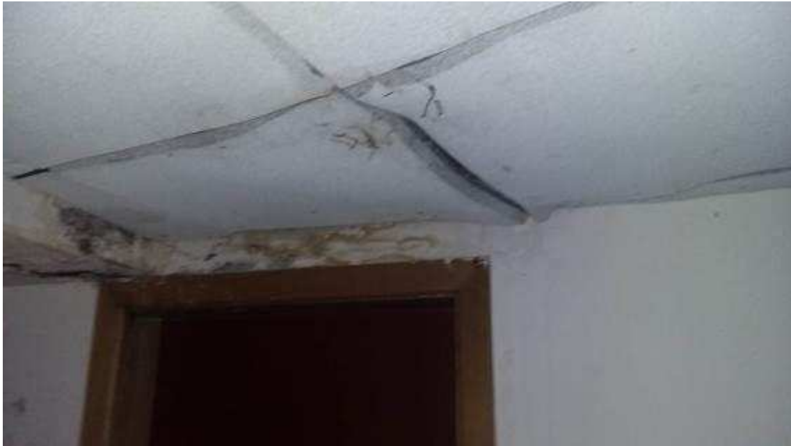
Sistema de proteção acústica sem eficiência, forma de norma e um risco para os usuários
