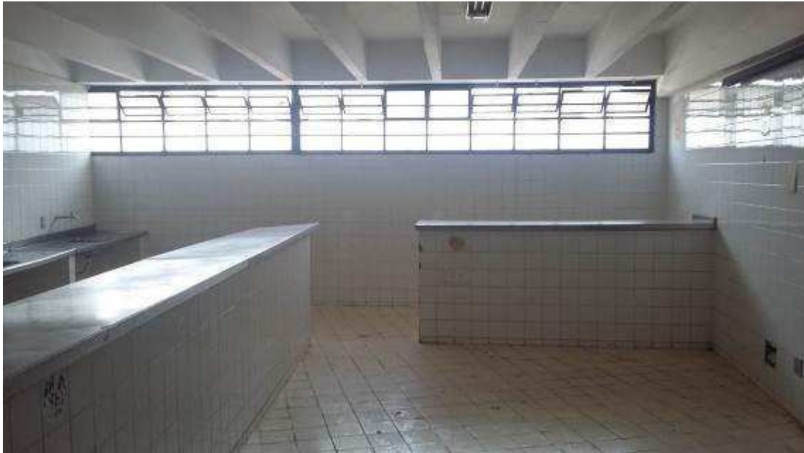
Necessidade de melhorias no ambiente dos 8 (oito) bares, com novo projeto atendendo as normas vigentes da Vigilância Sanitária para funcionamento de com fornecimento de bebidas e alimentos.
