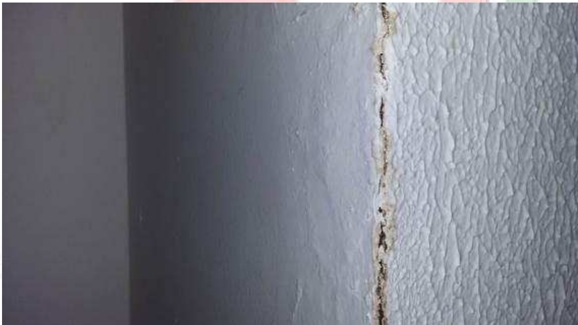
Instalação de anomalias em toda área interna do estádio em paredes, pisos com infiltrações no teto.
