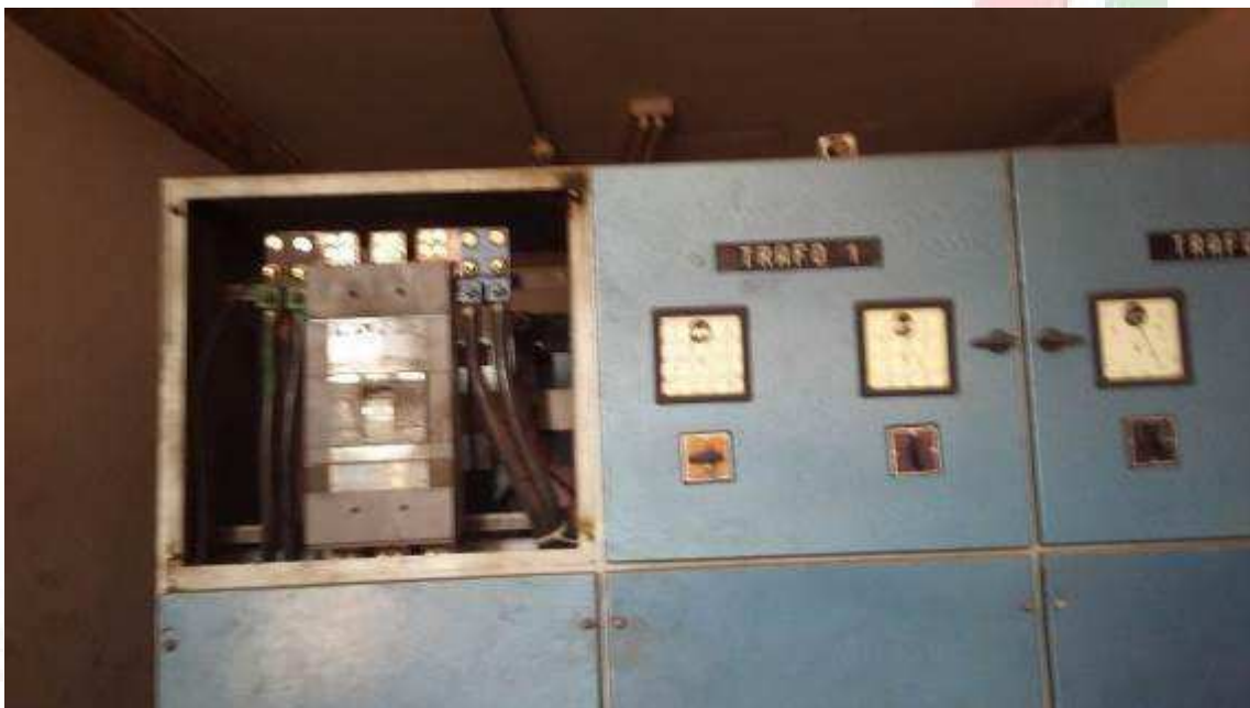
Sistema sem proteção com risco de acidentes
