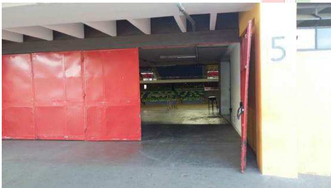
Figura 16 – Portões de acesso aos bares, utilizados também como saída de emergência.
