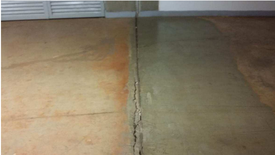
Figura 06 – Junta de dilatação na horizontal executado com material inapropriado deixando evidente a fadiga do mastique, permitindo a passagem de água durante a limpeza do pavimento superior, conforme mostra na figura abaixo.
