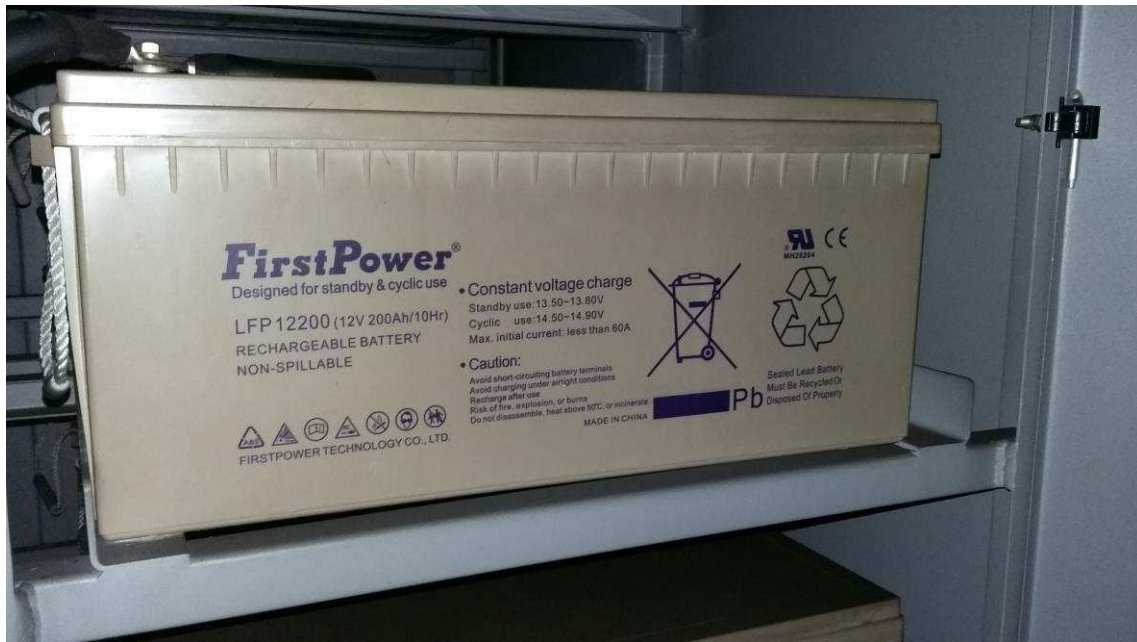
Figura 12 – Foto das baterias intacta para exemplificar a que foram destruídas pelo fogo
