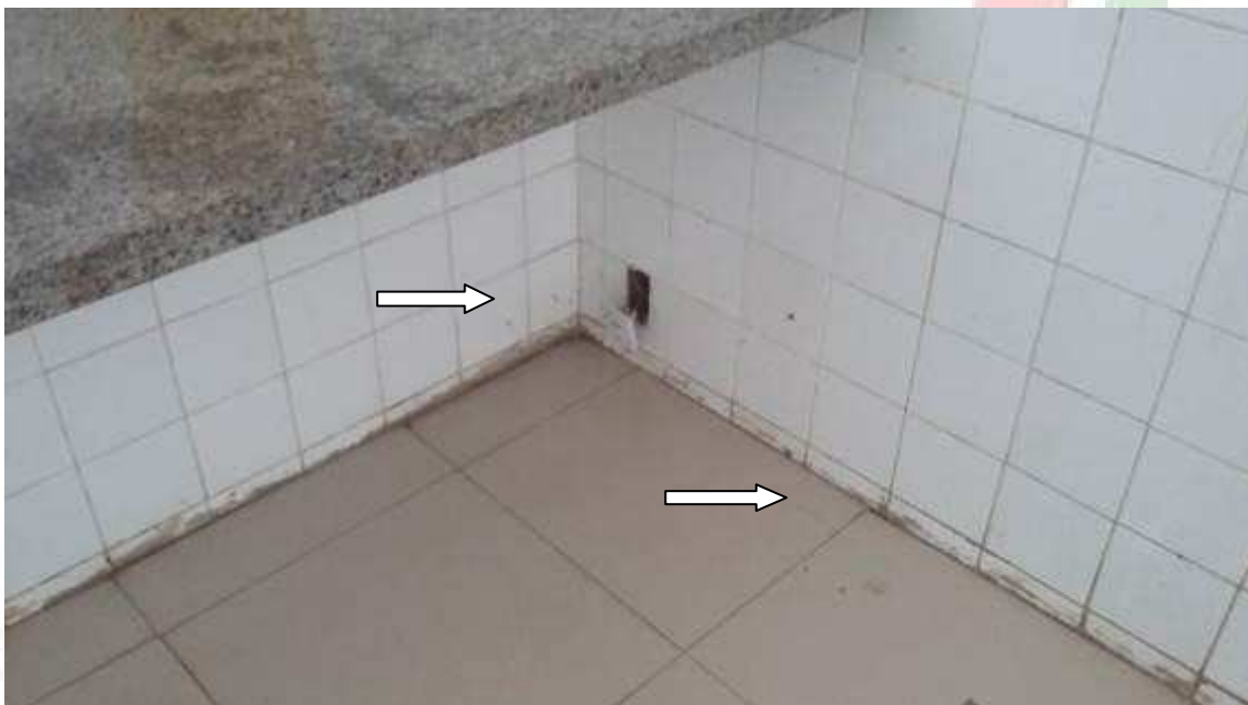
Anomalias nas instalações e área má conservada com sujeira e
