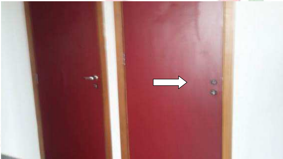
Porta mal conservada, sem condição de uso falta à maçaneta. (seta branca)
