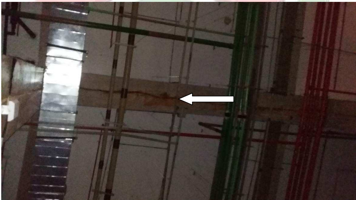
Figura 01 – Seta Branca – Aponta para a deformação que a estrutura vem sofrendo devido ao tempo de uso, diferença brusca de temperatura, e as sobrecargas do sistema de coberturas, contribui para as instalações de anomalias.
