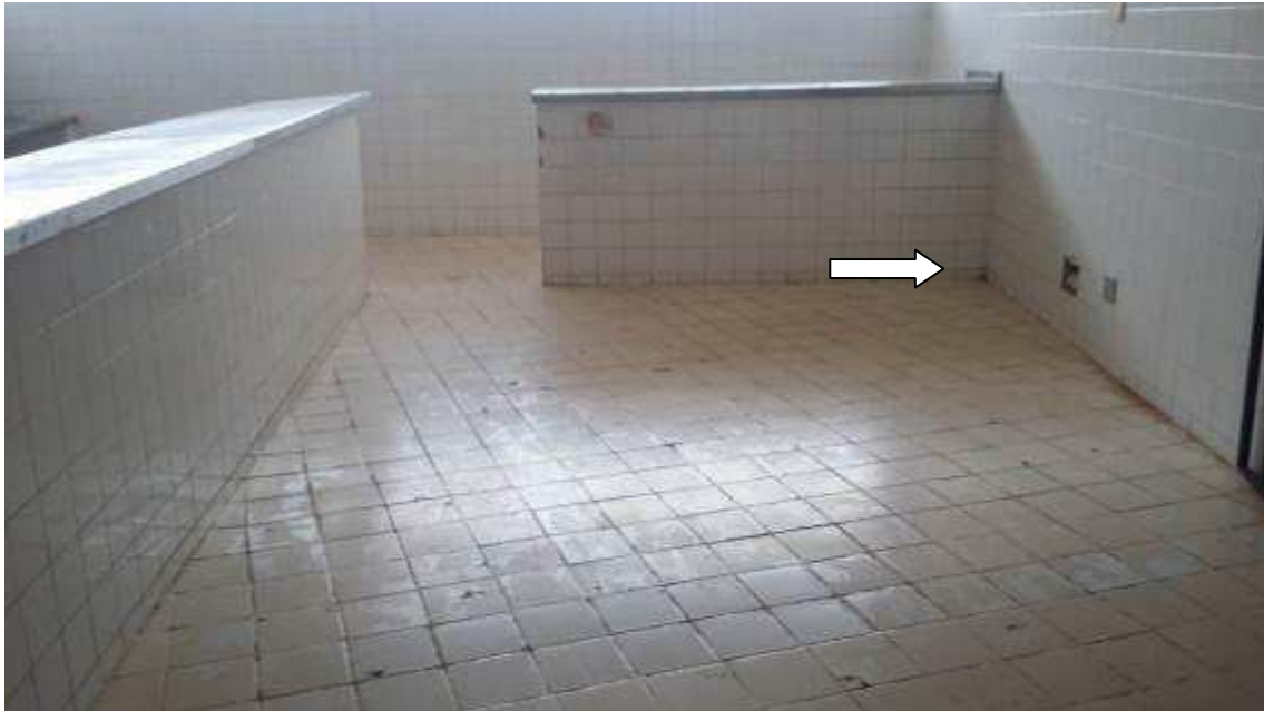
Ambiente já com todo o sistema de revestimento comprometido, anomalias nas instalações. Seta branca
