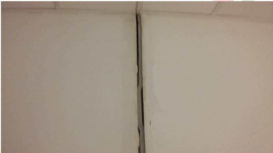
Figura 05 – Junta de dilatação na horizontal executado com material inadequado deixando evidente a fadiga do mastique, permitindo a passagem de água durante a limpeza do pavimento superior, conforme mostra na figura abaixo.
