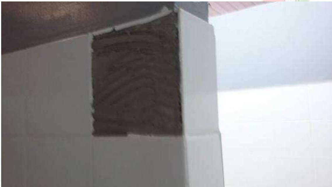
Necessidade de reforma conforme mostra figuras
