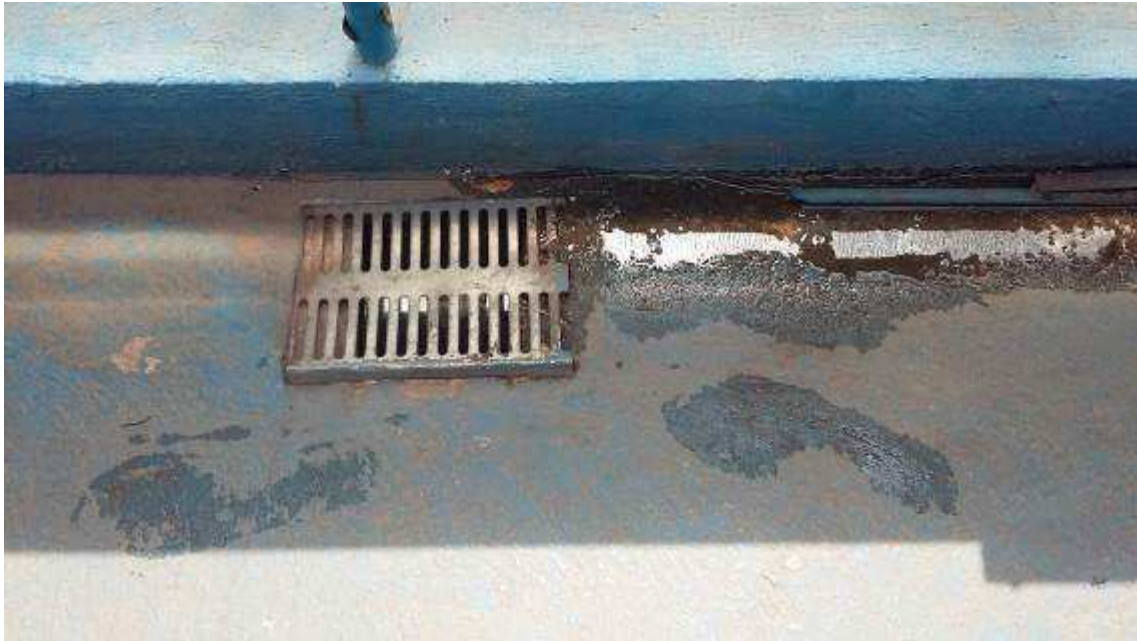
Acumulo de água próxima a captação de água pluvial, grelha com parte danificada.
