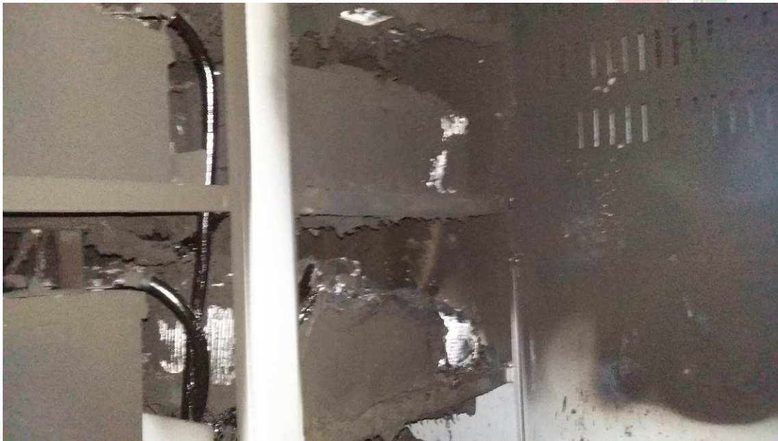
Figura 11 – Nesta foto mostra o incêndio na casa das baterias – Nobreak onde houve a queima de 32 unidades de baterias em duas torres..
