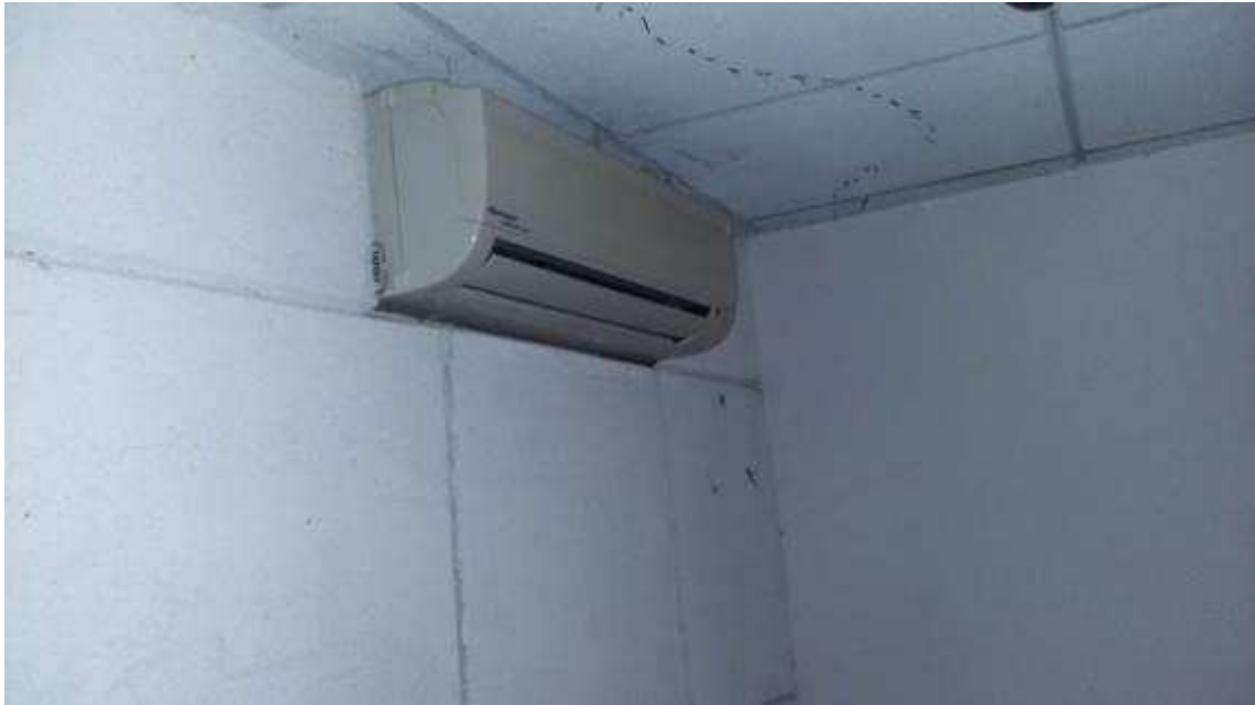
OS aparelhos de ar condicionado apresenta aspecto de má conservação devido ao próprio tempo de uso e falta de limpeza e correções preventivas.
