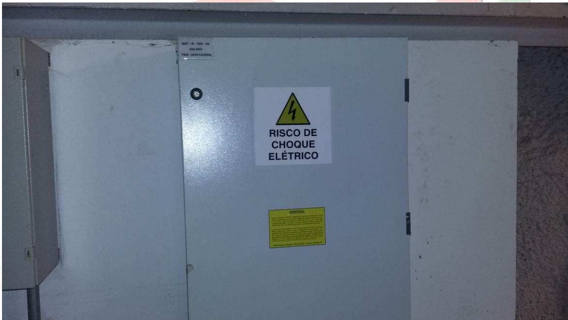
Figura 09 – Sala de baterias localizada próximo ao Raio 50
