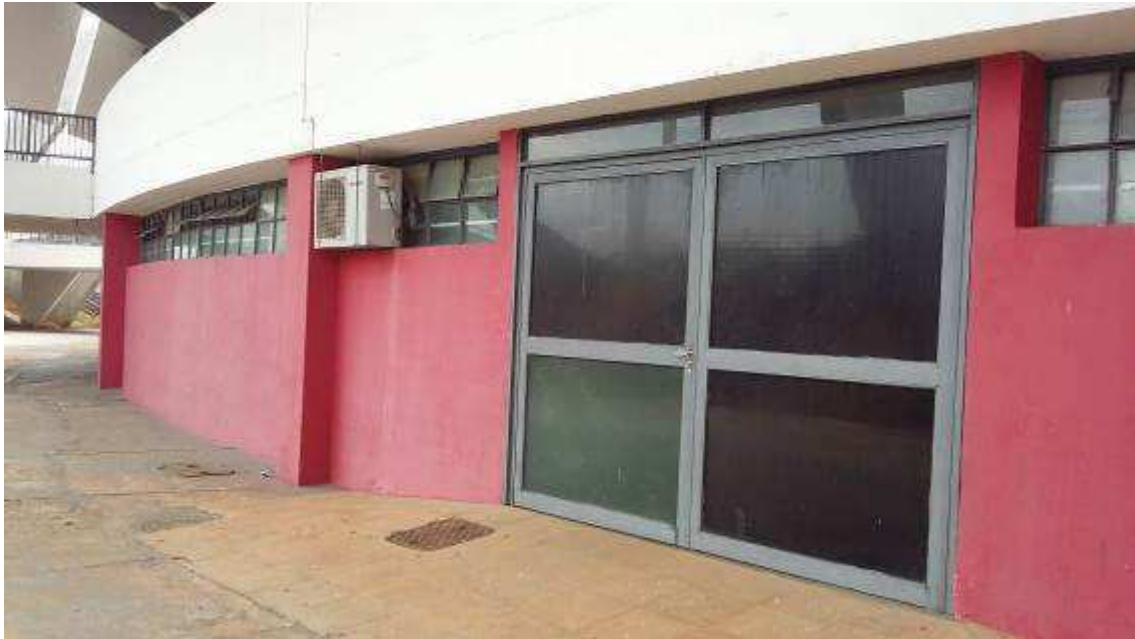
Necessidade de pintura geral externa na fachada
