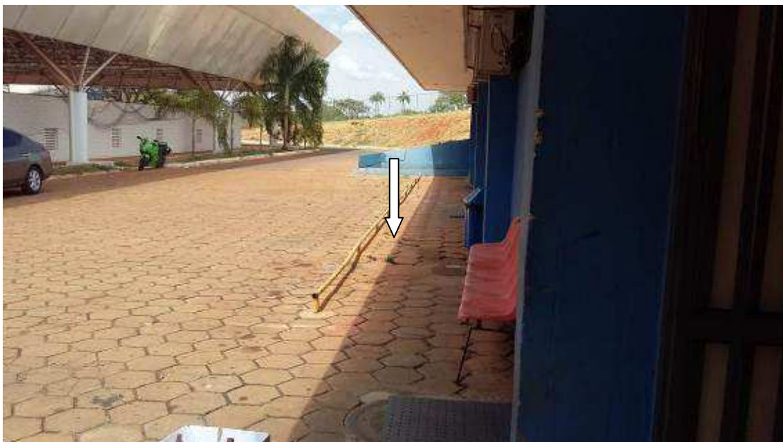
Área externa com vários pontos de anomalias e irregularidades
