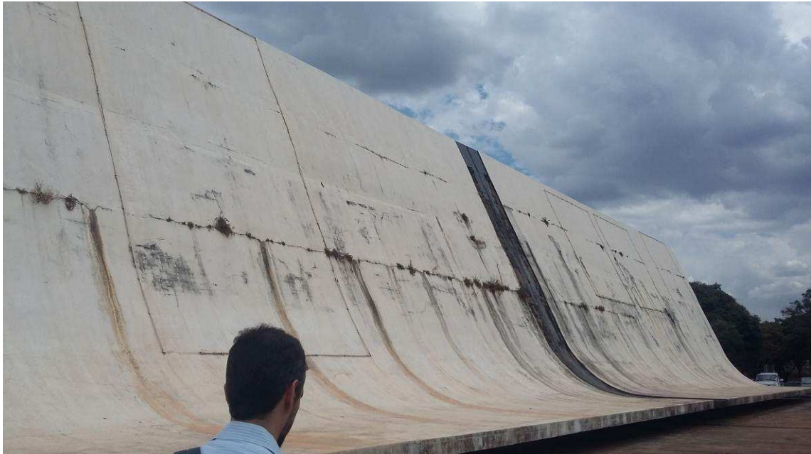
Figura 02 – Fachada lateral sul, denunciando a falta de manutenção, estrutura de concreto armado com patologias instaladas em todo o perímetro da cortina côncava.
