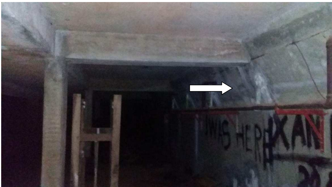
Figura 11 – Vários pontos de infiltração na antiga piscina conforme mostra a seta branca
