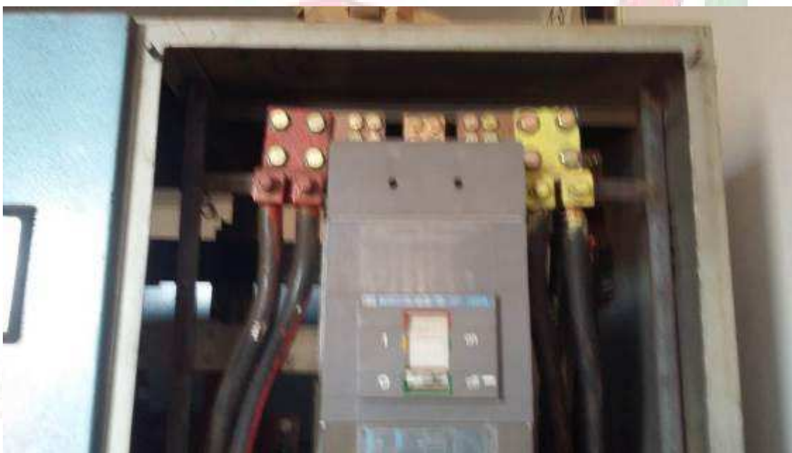
Possibilidade de acidente falta de proteção
