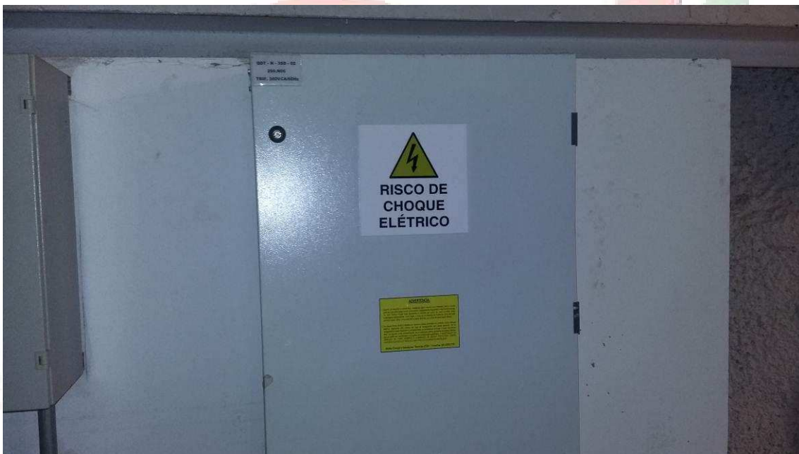
Figura 09 – Sala de baterias localizada próximo ao Raio 50
