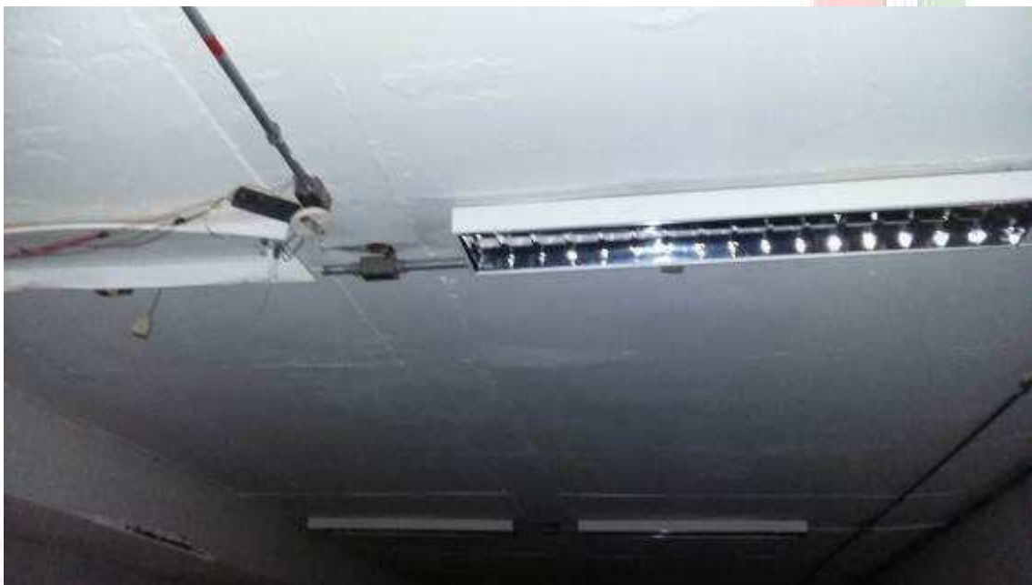
Necessidade de substituição do sistema de iluminação
