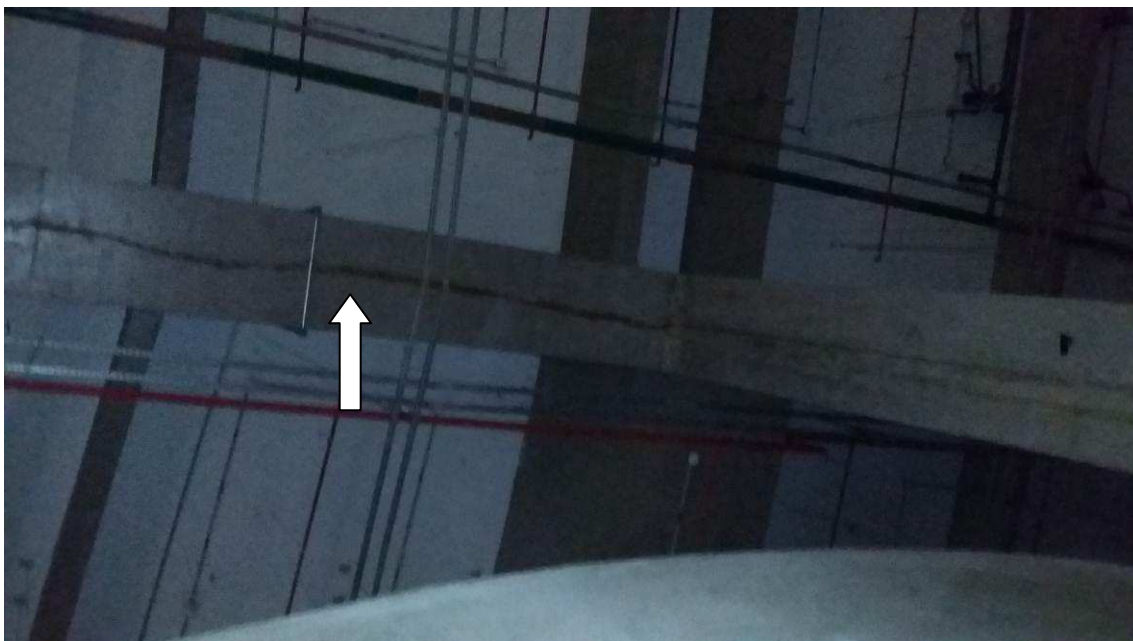
Figura 02 – Descontinuidade na junta de dilatação.
