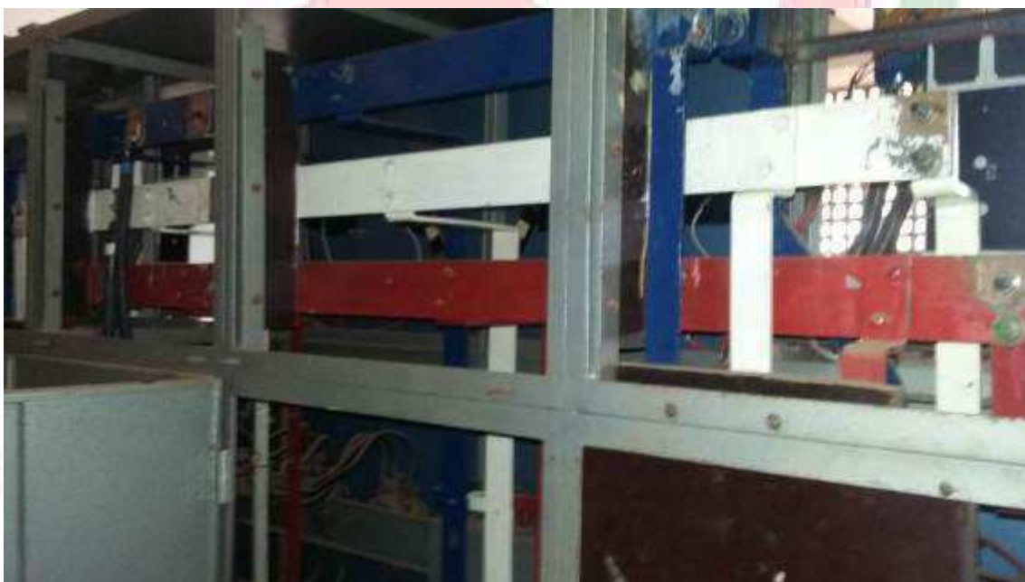
CASA DE FORÇA - Barramento sem nenhuma proteção
