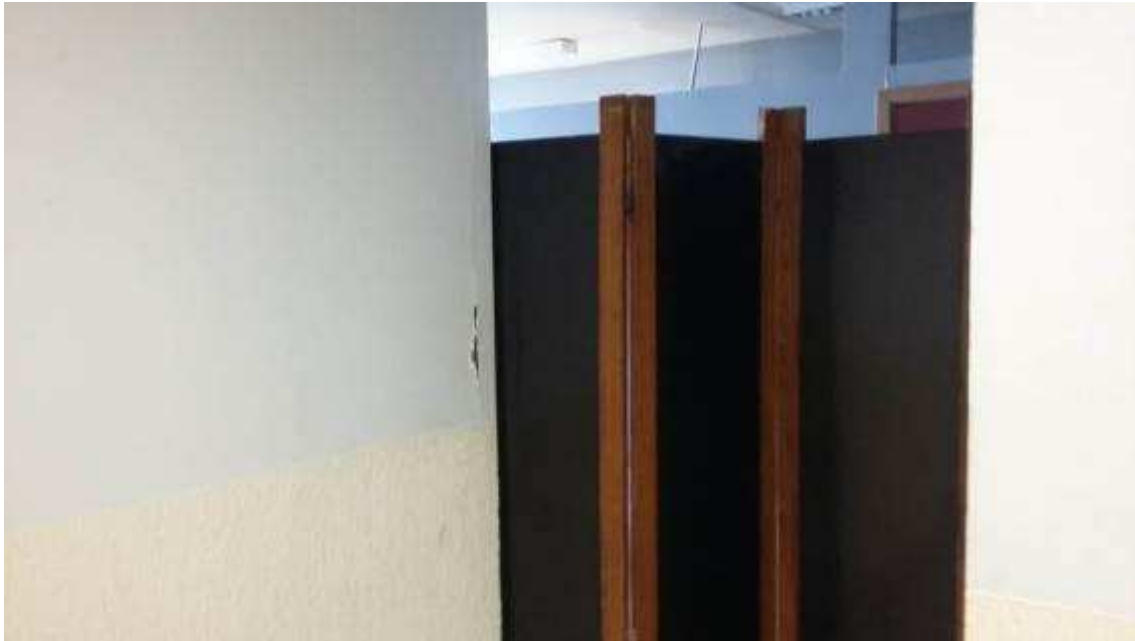
Falta de correção preventiva
