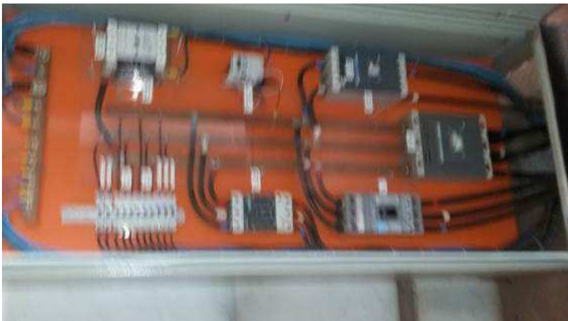
Quadro com modificações recente, sem proteção.
