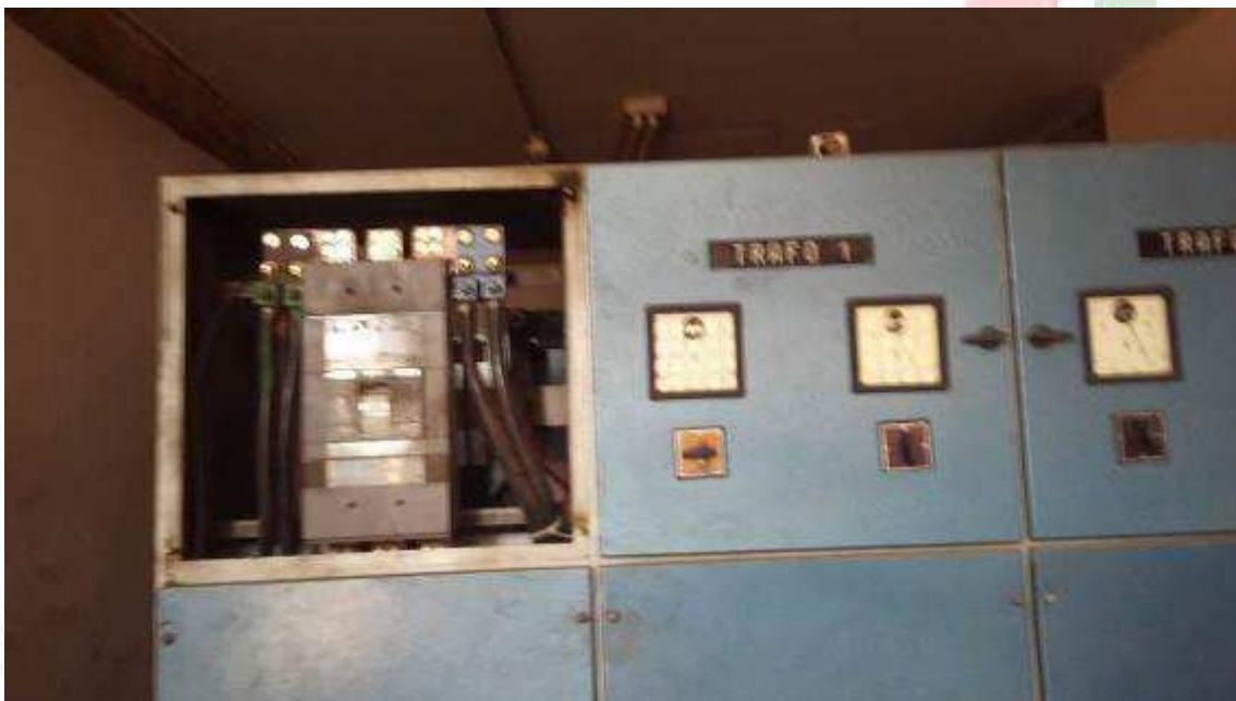
Sistema sem proteção com risco de acidentes
