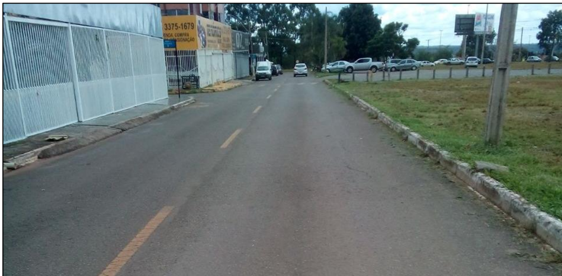
Figura 12 - Trechos de via sem captações
