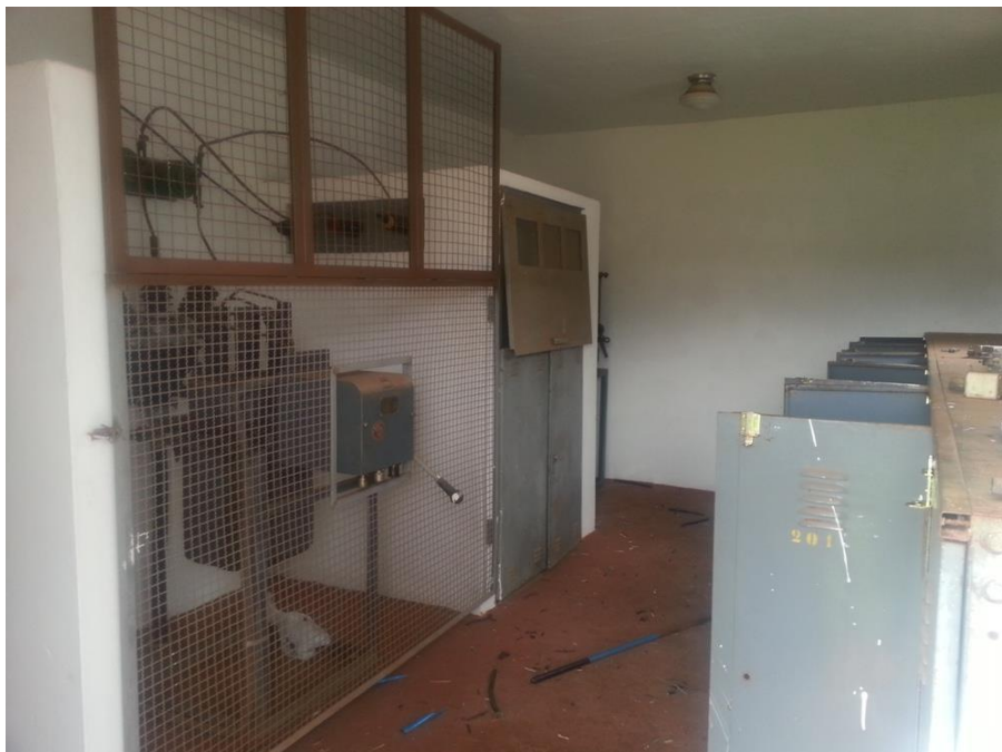
Figura 16: Vista interna da subestação de energia elétrica.
