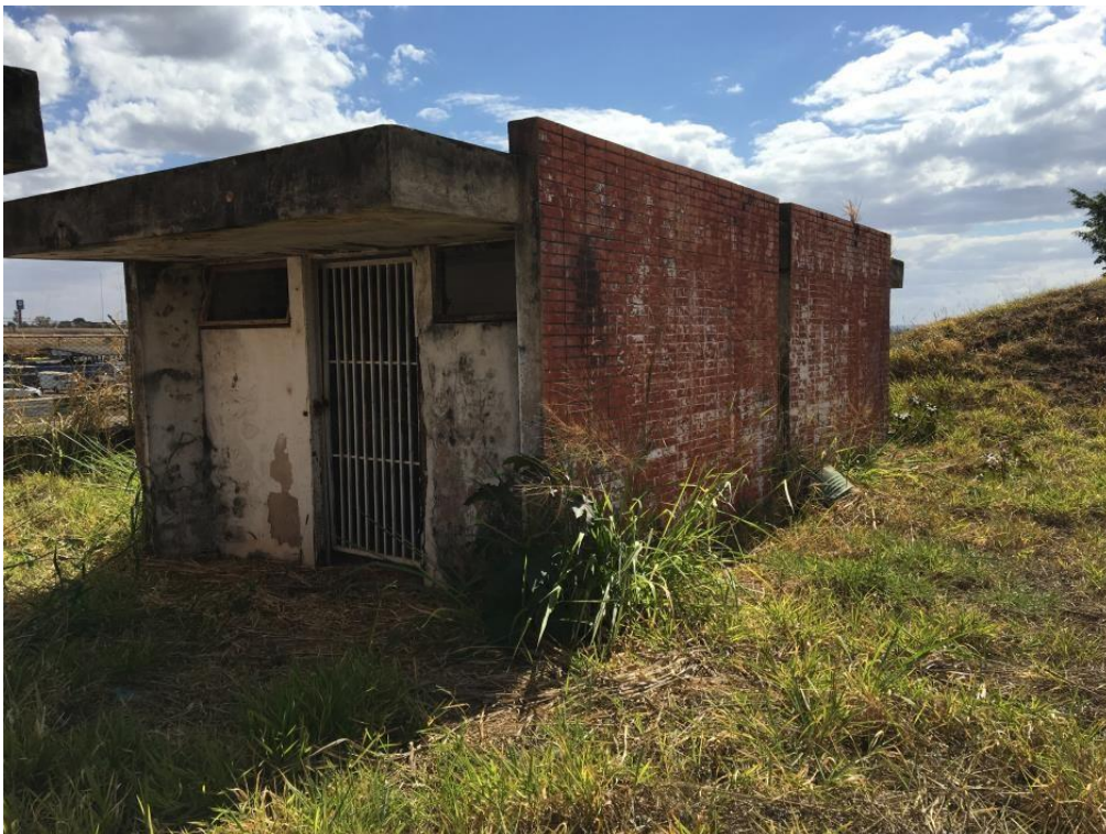
Figura 20: Estrutura de apoio degradada.
