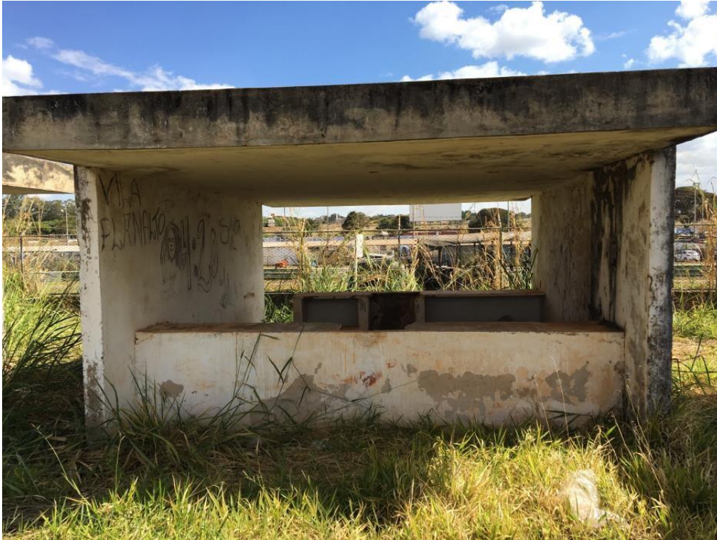
Figura 19: Estrutura de apoio degradada.
