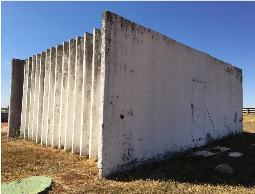
Figura 15: Vista externa da subestação de energia elétrica.
