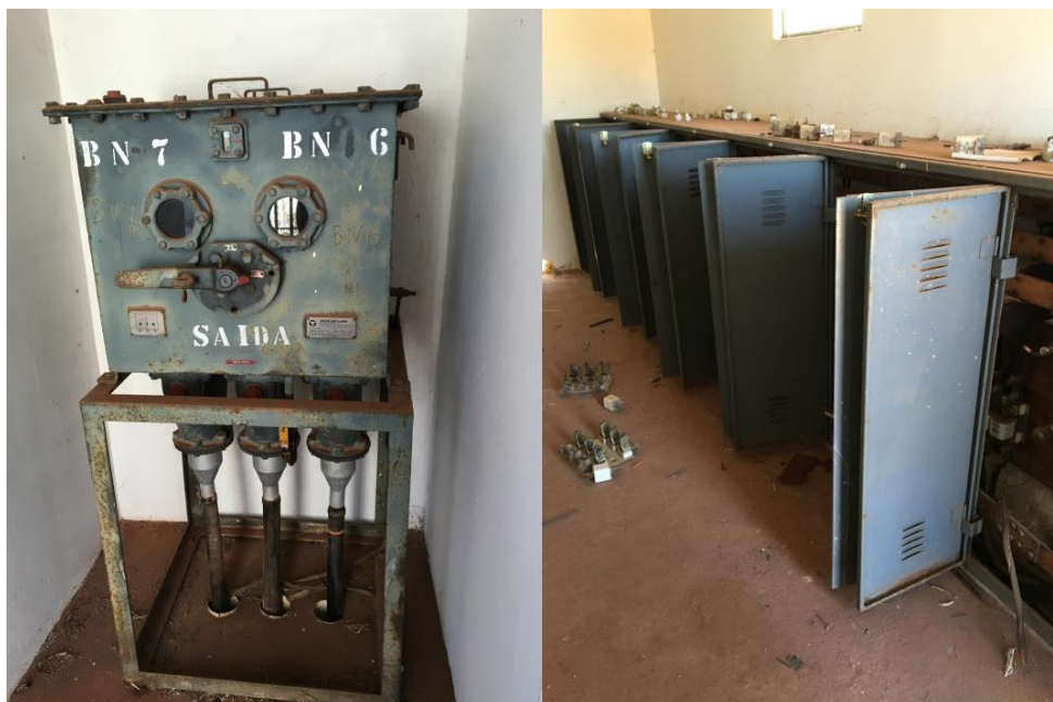
Figura 17: Detalhes da subestação de energia elétrica.
